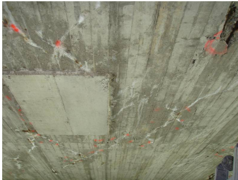
Figure 3.1 – Vue du patron de fissuration du dessous de la travée Nord
