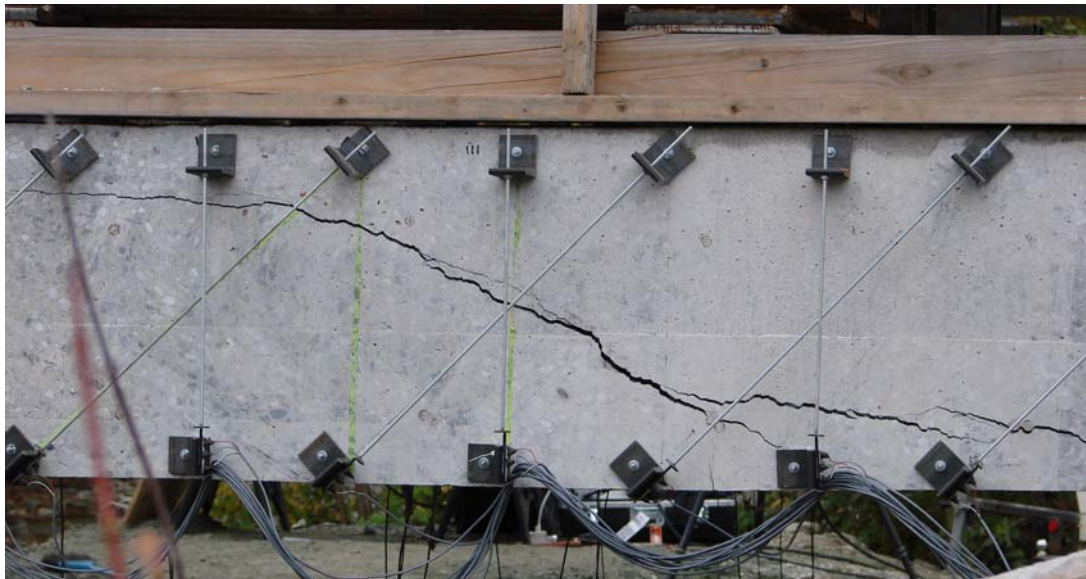
Figure 5.28 – Fissure en cisaillement – 2 de 4 ( V \approx 450 \text{ kN/m} )
