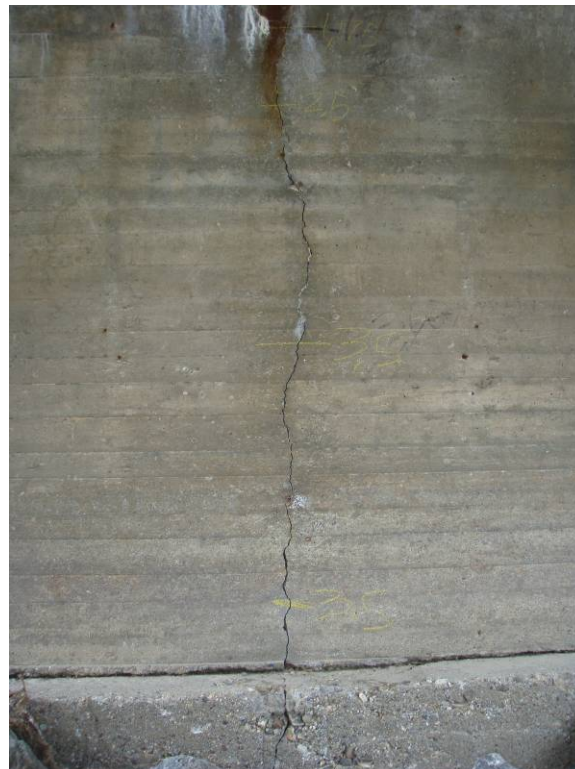
Figure 3.3 – Fissuration verticale dans la pile
