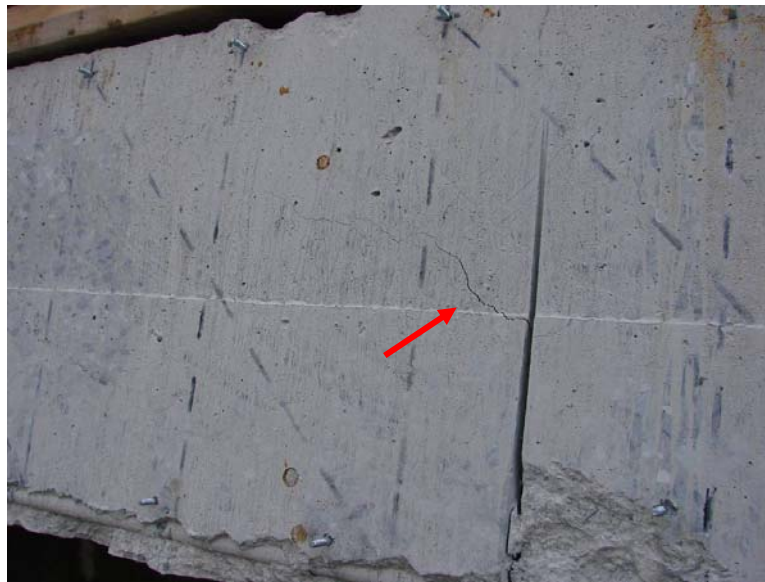
Figure 5.56 – Fissure du côté Sud-Est à la fin de l'essai
