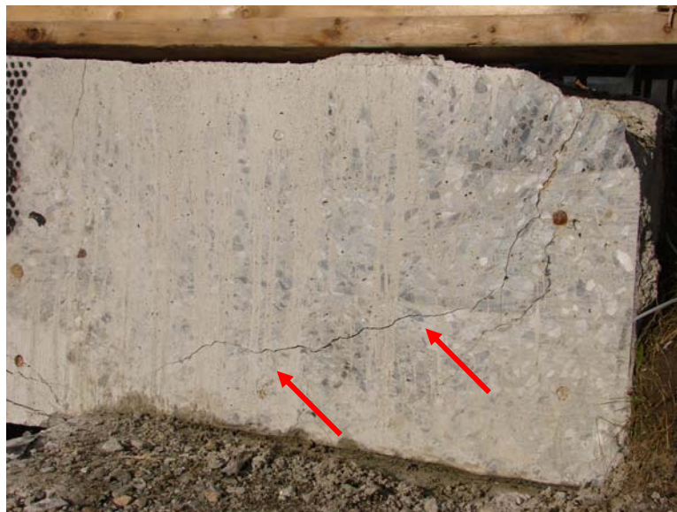
Figure 5.55 – Fissure dans la partie de la dalle appuyée sur la culée à la fin de l'essai (culée Sud-Ouest)
