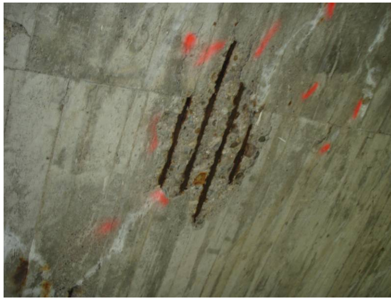
Figure 3.2 – Vue du délaminage au dessous de la travée Nord
