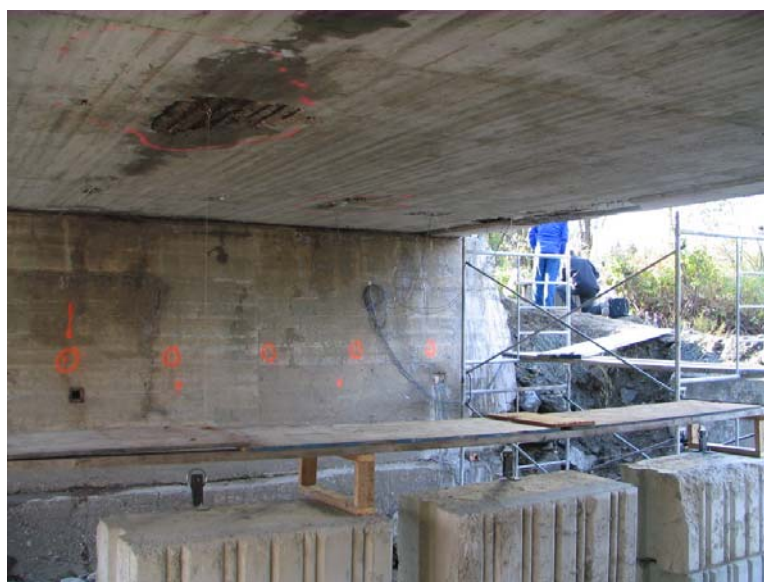
Figure 5.62 – Présence de délamination au centre de la travée Sud
