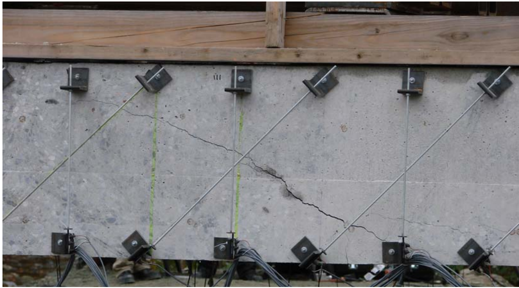
Figure 5.27 – Fissure en cisaillement – 1 de 4 ( V \approx 350 \text{ kN/m} )
