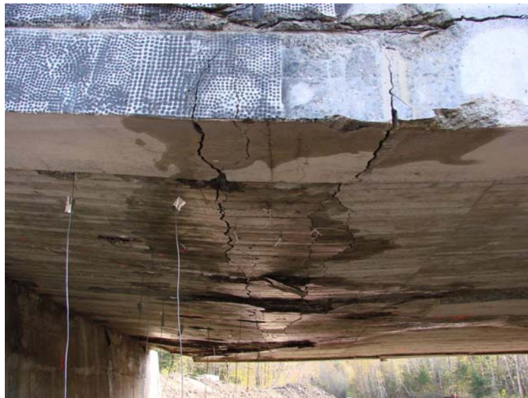
Figure 5.15 – Rupture en flexion du côté Nord-Ouest
