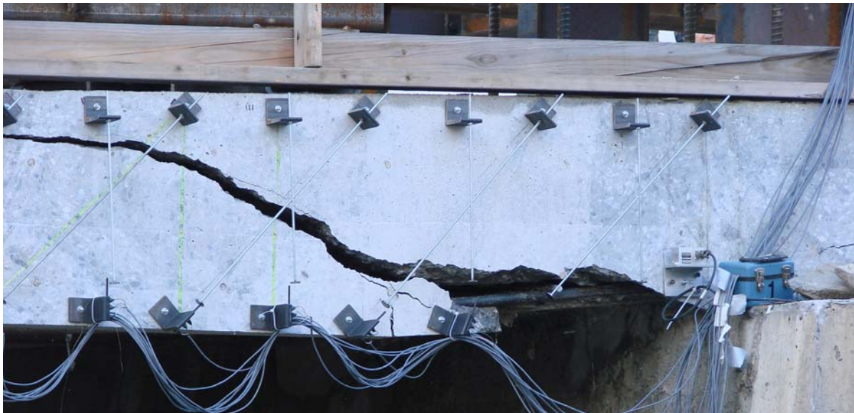
Figure 5.30 – Fissure en cisaillement – 4 de 4 (post-pic)
