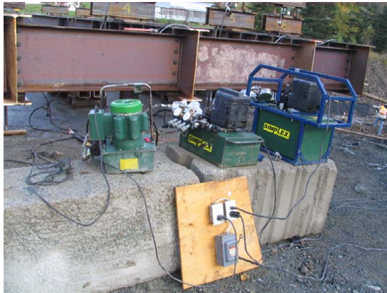
Figure 4.15 – Pompes électriques actionnant les vérins
