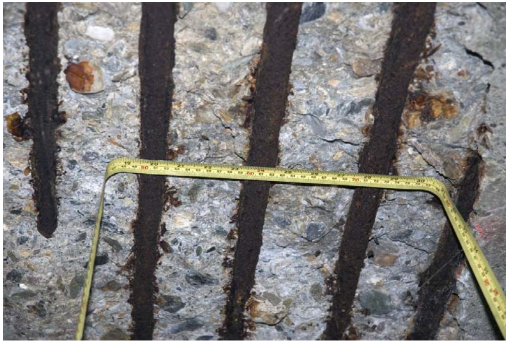
Figure 3.6 – Espacement et corrosion des armatures de la travée Nord
