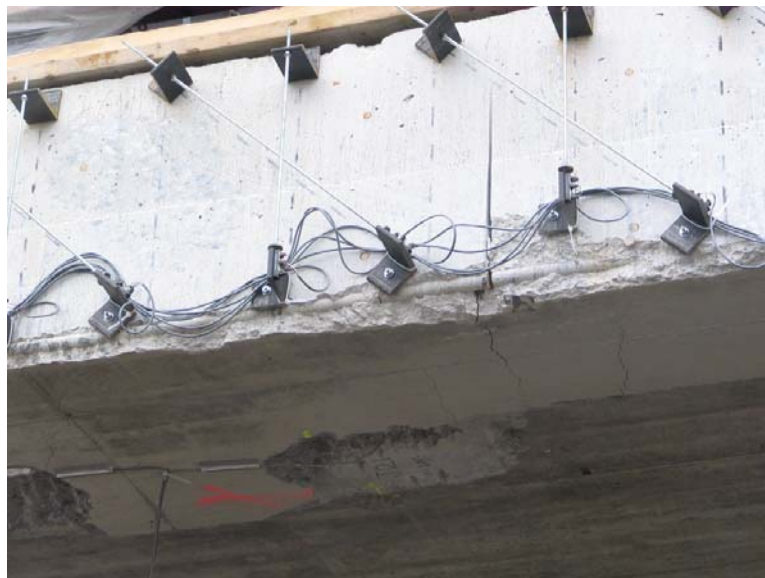
Figure 5.48 – Rupture partielle en flexion du côté Sud-Est
