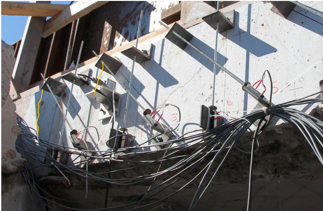
Figure 3.8 – Fissure verticale en partie supérieure au droit du support de la culée, coin sud-est
