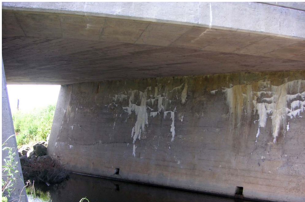
Figure 3.2 – Vue des traces d'efflorescences blanchâtres sur la culée nord.
