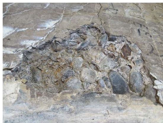
(b) Épaufrure sur le mur interne de la culée
