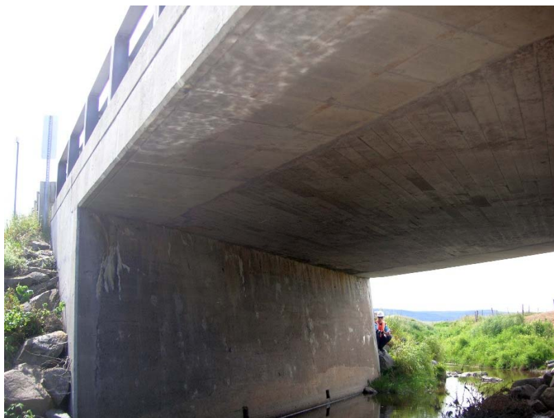
Figure 2.11 – Mise en évidence de l'élargissement d'extrémité - Vue de la culée Sud côté aval (juillet 2013)
