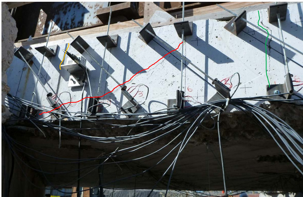
Figure 3.6 – Fissures de cisaillement et flexion présente avant les essais de chargement, coin sud-est
