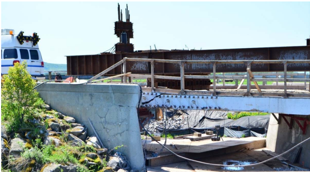
Figure 5.15 – Vue globale de la rupture en cisaillement du pont
