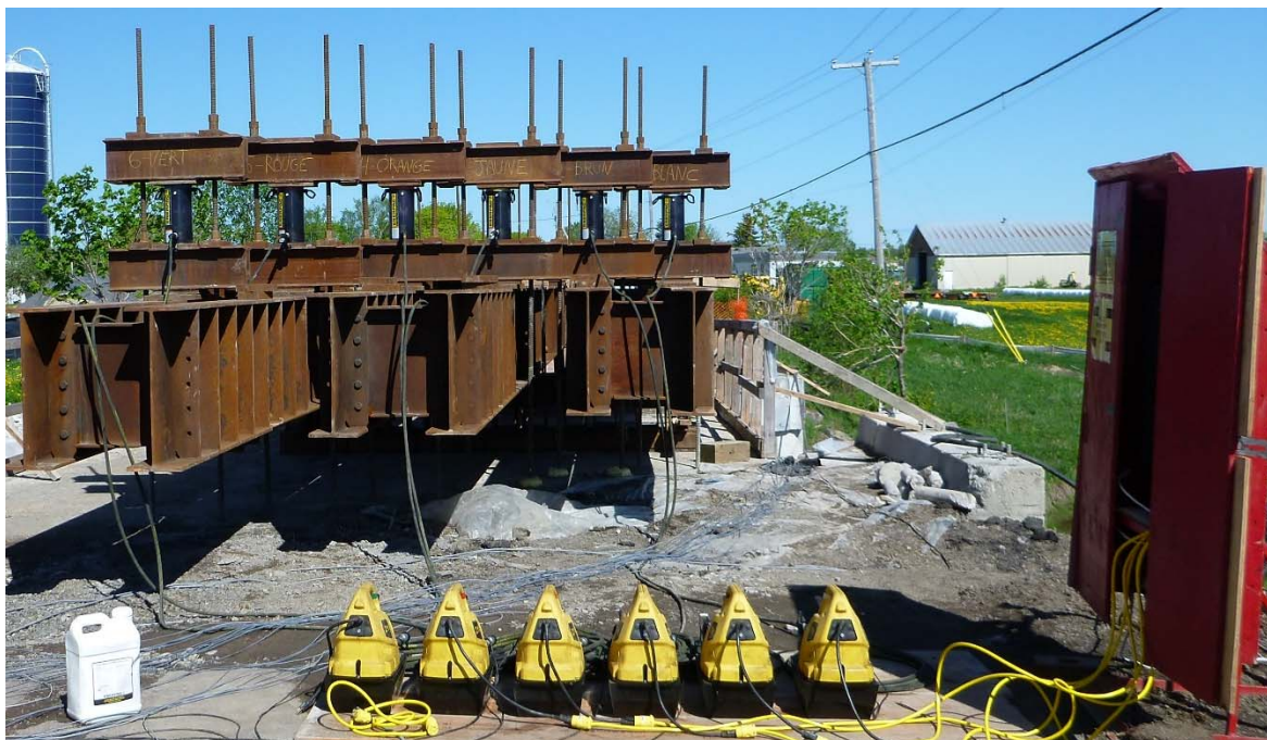
Figure 4.12 – Pompes électriques actionnant les vérins
