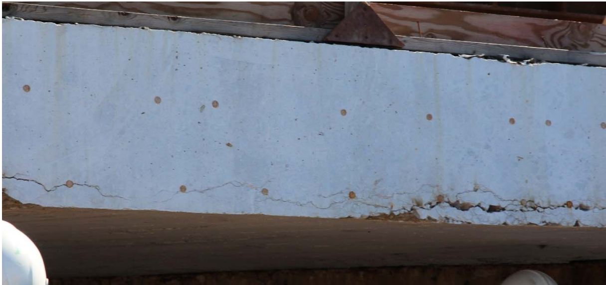
Figure 3.11 – Plan de fissuration au niveau des lits inférieurs d'armature de la dalle – côté amont direction sud
