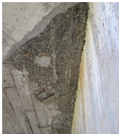
(a) Épaufrure à la connexion dalle-culée
