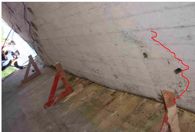
Figure 5.20 – Endommagement en sous face de la dalle
