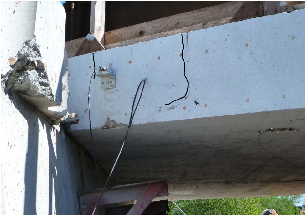
Figure 3.9 – Fissures de flexion angle nord-est présente avant les essais de chargement, coin nord-ouest
