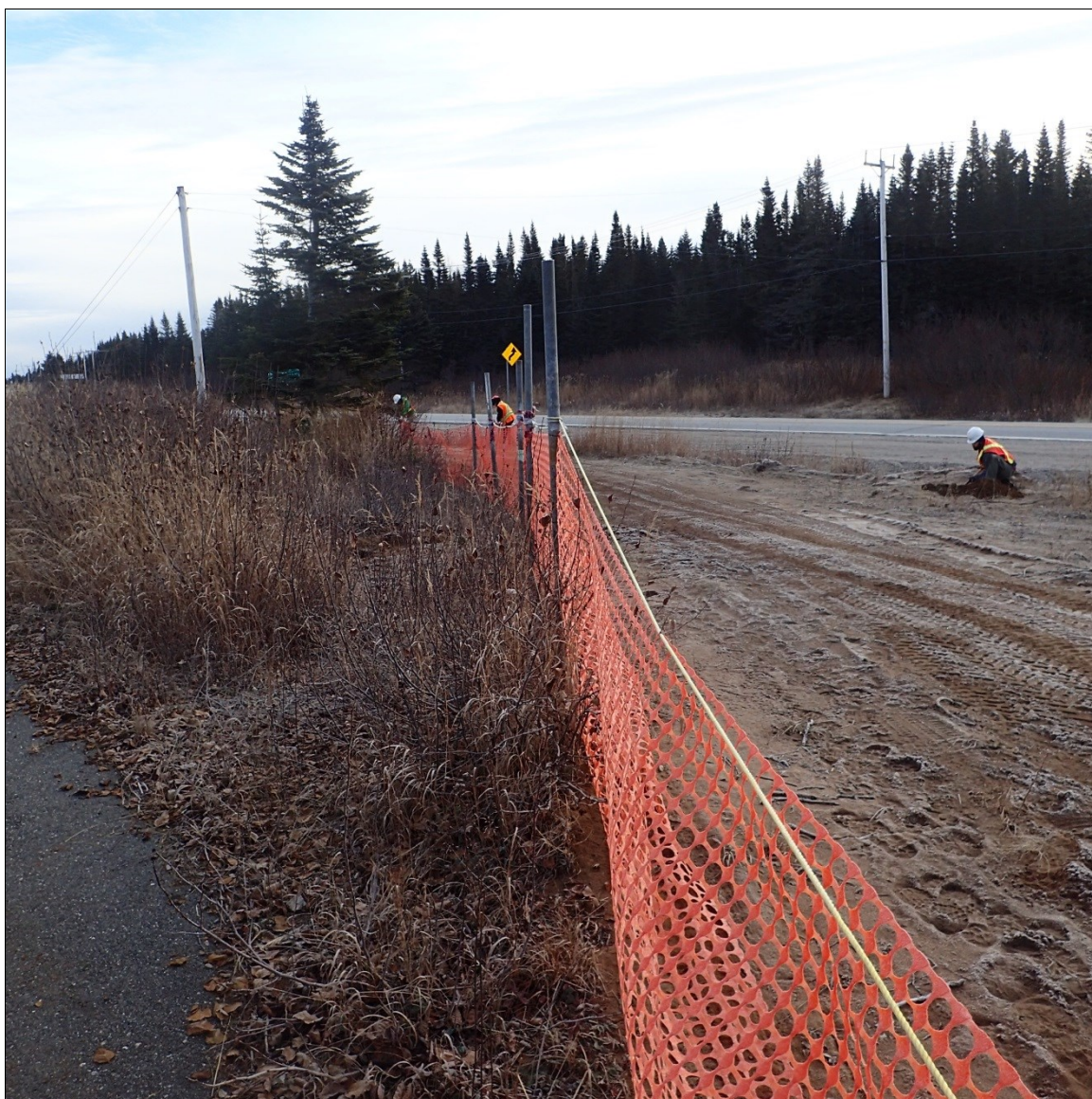
Photo 24 : Projet 154-02-0502, illustration démontrant étroitesse de la zone positive entre les infrastructures routières et la piste cyclable
