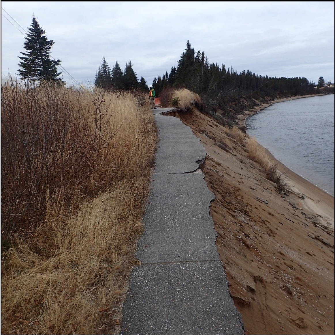
Photo 17 : Projet 154-02-0502, zone active d'érosion
