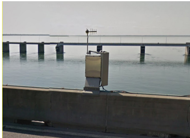
Image 2 : Station de monitoring installée sur la glissière du pont Champlain
