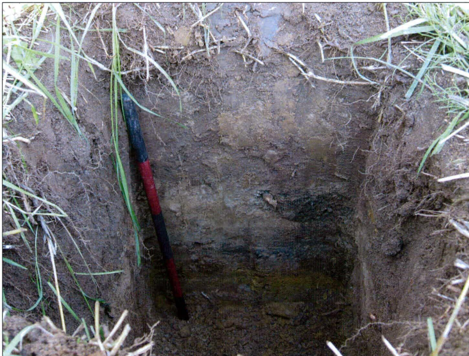
Photo 43 : Projet n° 154-06-1561, ponceau n° 0648-0, route 132, municipalité de Lotbinière, paroi ouest d'un sondage. Direction ouest (photo 154-06-1561-5)
