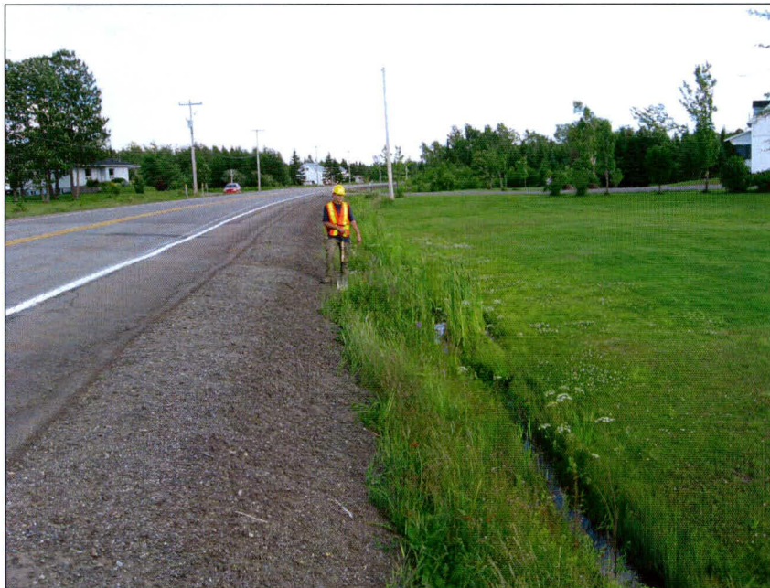
Photo 22 : Projet n° 154-06-1564, ponceau n° 4206-0, route 204, municipalité de Tourville, vue générale de l'emprise du côté sud de la route. Direction est (photo 154-06-1564-32).
