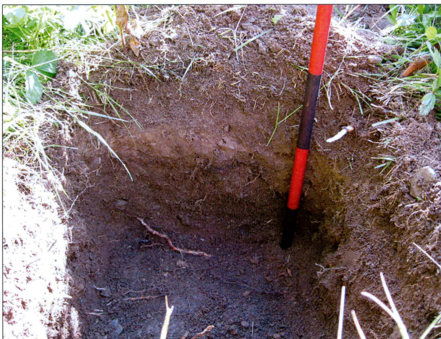
Photo 14 : Projet n° 154-06-1564, ponceau n° 5081-0, route 285, municipalité de Saint-Cyrille-de-Lessard, Paroi est du sondage. Direction est (photo 154-06-1564-6).
