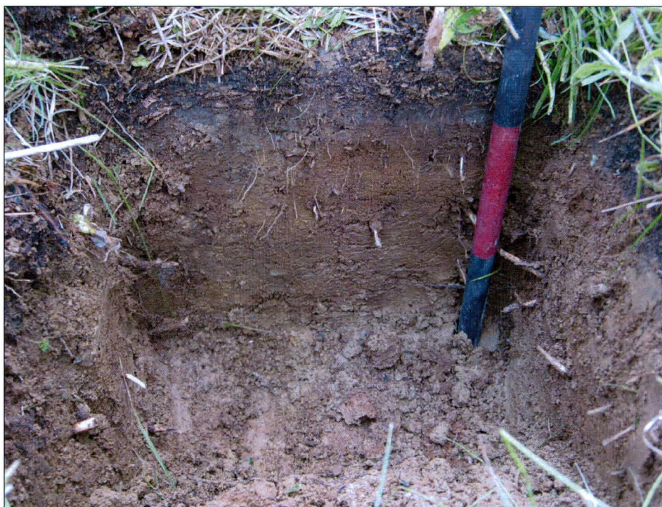
Photo 65 : Projet n° 154-03-0197, ponceau n° 12524, route 271, ville de Saint-Georges, paroi ouest d'un sondage du côté nord-ouest de l'emprise. Direction ouest. (photo 154-03-0197-15)
