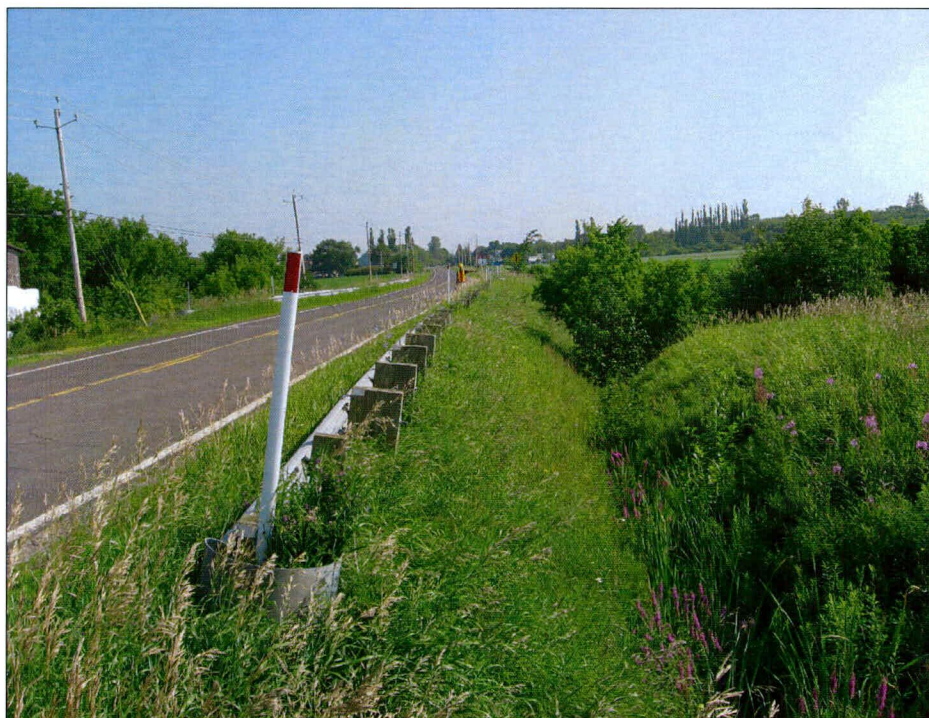
Photo 38 : Projet n° 154-97-0280, ponceau n° 0643-0, route 132, municipalité de Lotbinière, vue générale de l'emprise du côté est de la route. Direction nord-est (photo 154-97-0280-1).
