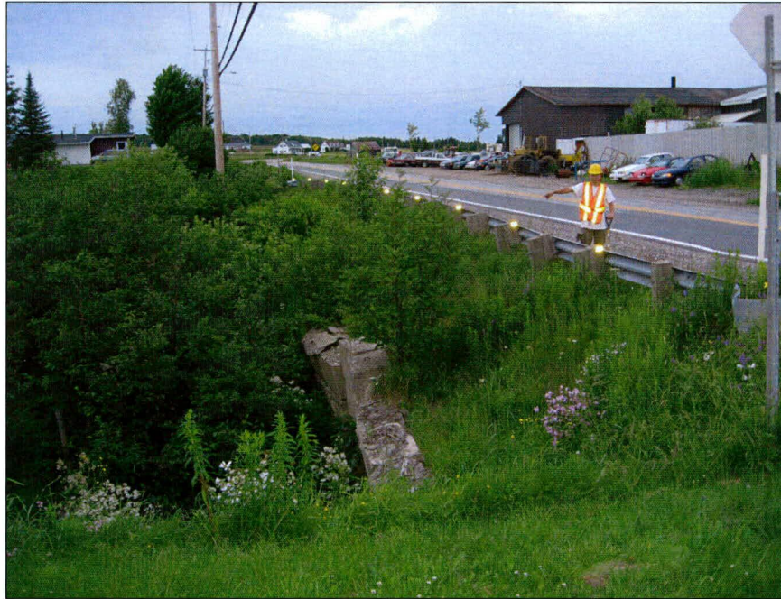
Photo 68 : Projet n° 154-03-0197, ponceau n° 16582, route 112, municipalité Saint-Frédéric-de-Beauce, vue générale de l'emprise du côté ouest de la route. Direction nord. (photo 154-03-0197-38)
