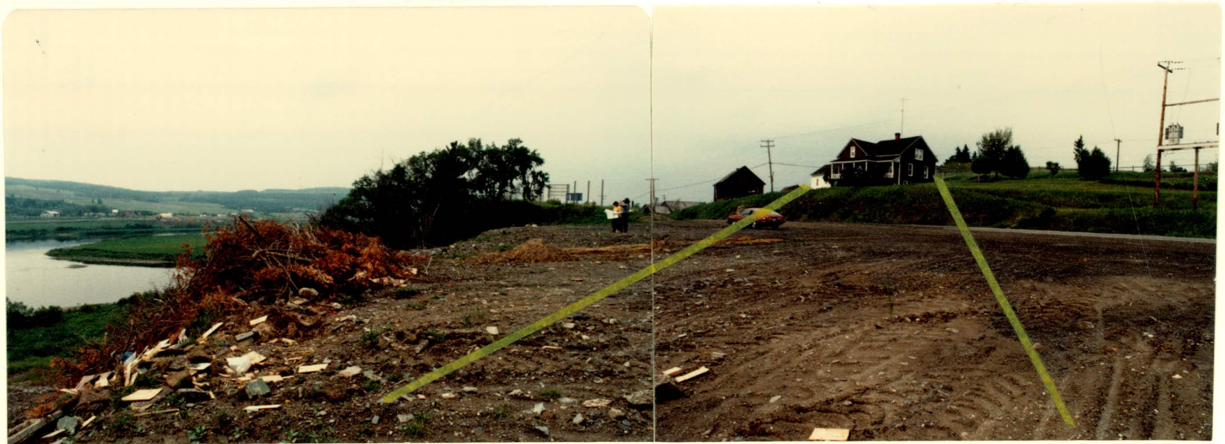
PHOTO 16: A l'entrée de Saint-Georges, remblais déjà existants dans une partie de la plaine de débordement. En haut, à droite, quelques bâtiments qui seraient expropriés par le passage de l'autoroute.
