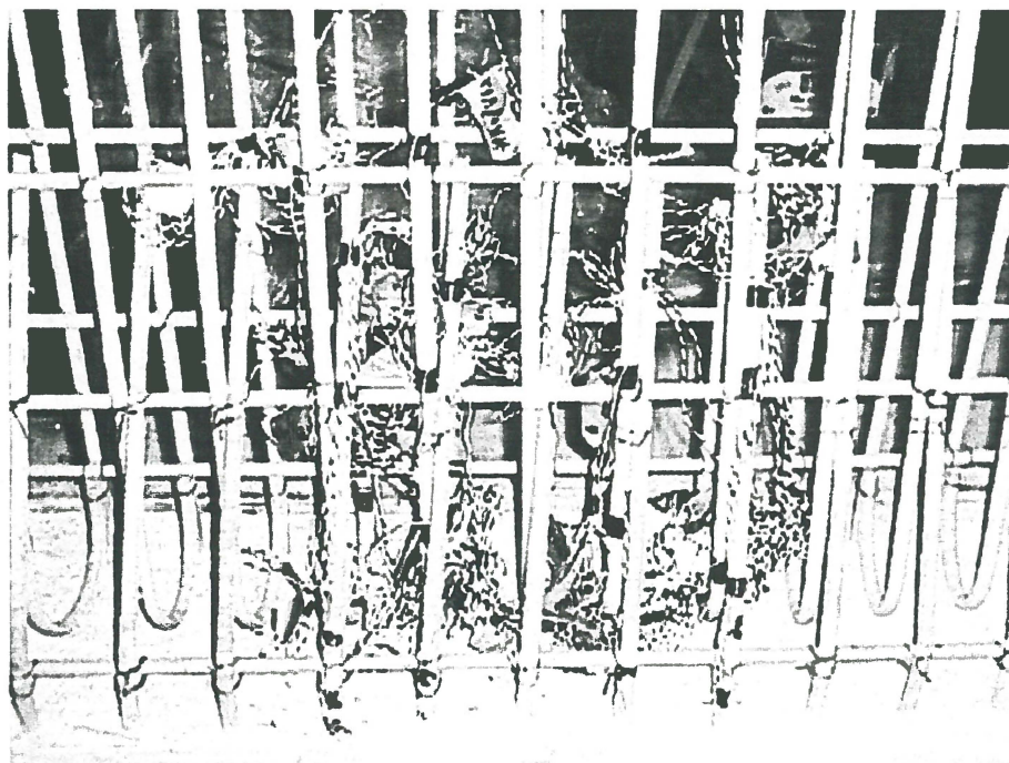
Figure 2.10 Vue rapprochée de l'armature de la glissière PL2-CB1
