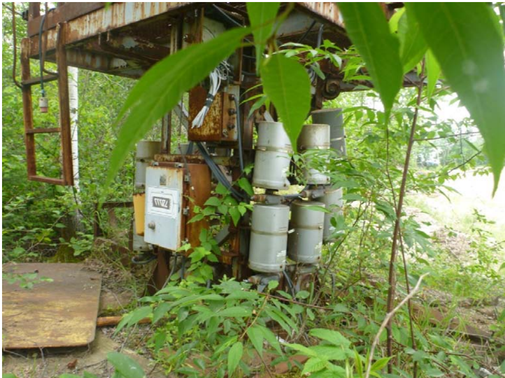
Photo 26, point 6 : équipement hydro-électrique et transformateur pouvant possiblement contenir des BPC abandonnés sur le site (8 au 19 juillet 2013)
