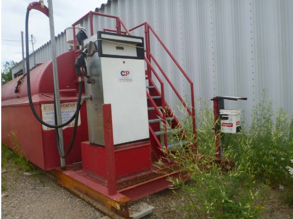
Photo 29, point 6 : réservoir et pompe sans tablier de béton, reposant directement sur le sol graveleux. Aucune tache ou odeur n'ont cependant été notée à cet endroit (8 au 19 juillet 2013)
