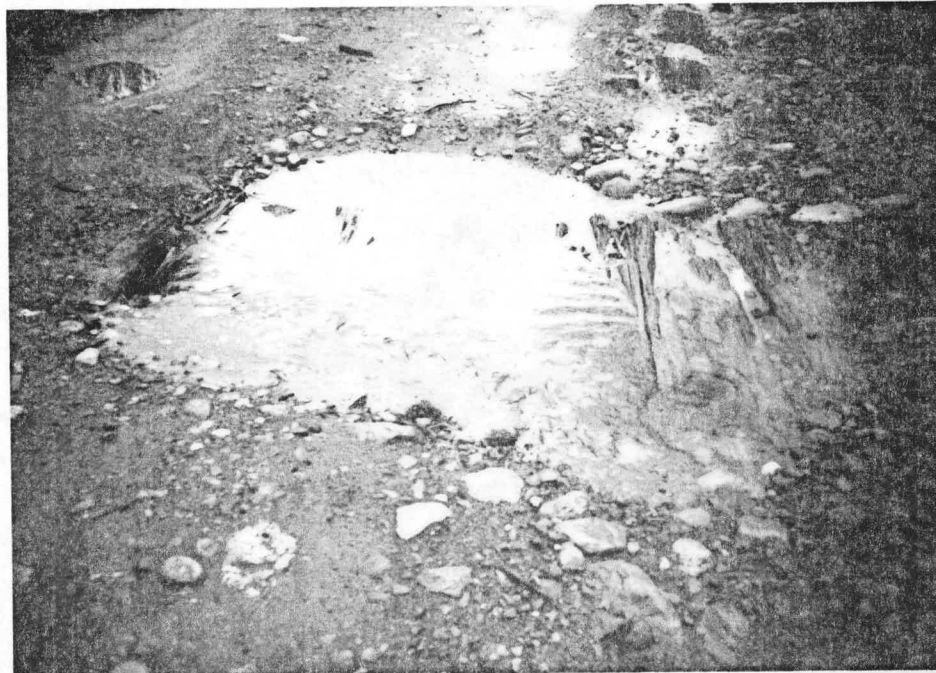
PHOTO 8: A certains endroits, les ruisseaux resurgent sur la route dû à l'effondrement des ponceaux.
