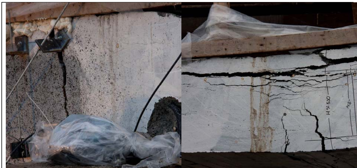
a) Ouverture de la fissure à la culée
