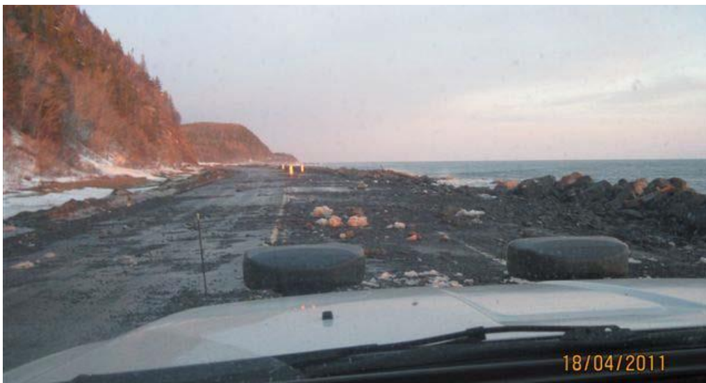
Figure 35. Projection de roches sur la chaussée de la 132 entre Marsoui et Rivière-à-Claude (© MTQ)
