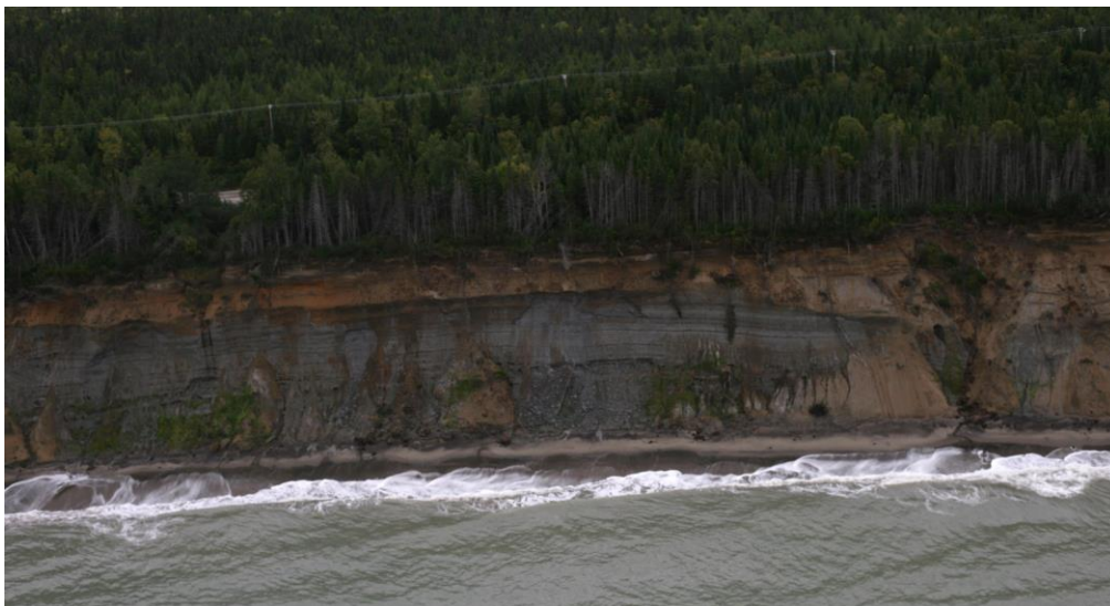
Figure 100. Segment avec une vulnérabilité à l'érosion critique d'ici 2060 – segment RSJ020 (© LDGIZC – UQAR, septembre 2010)
