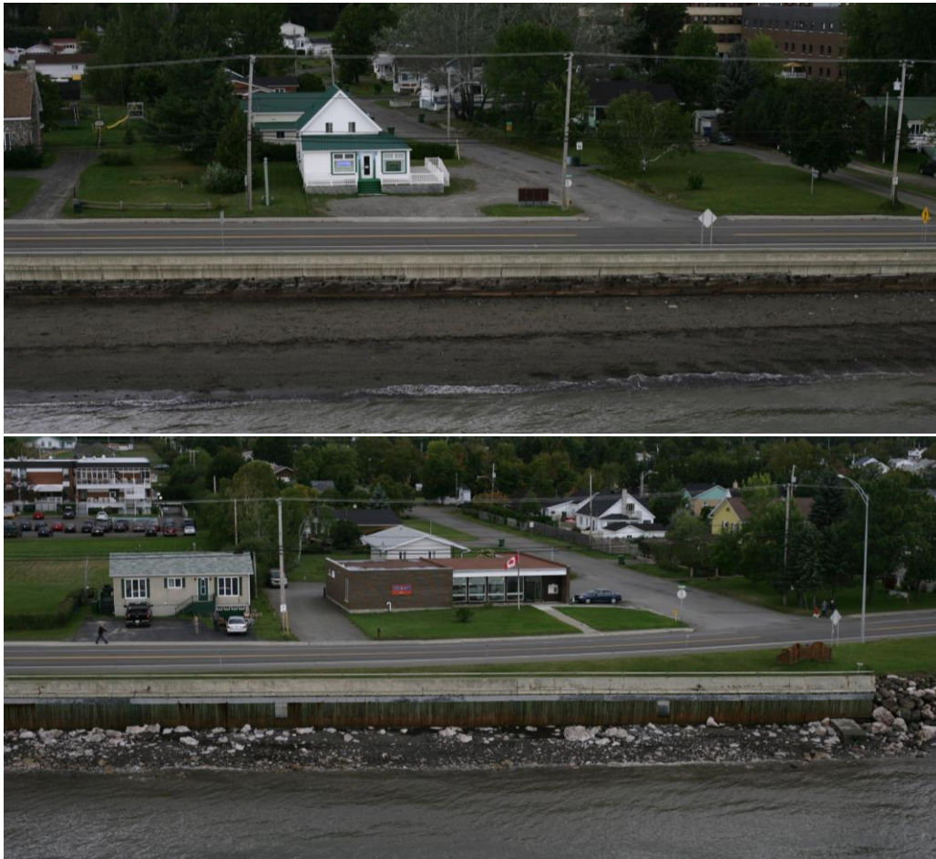
Figure 92. Segments avec une vulnérabilité critique actuellement - segments MAR078 et 079 (haut) et segment MAR087 (bas) (© LDGIZC – UQAR, septembre 2010)
