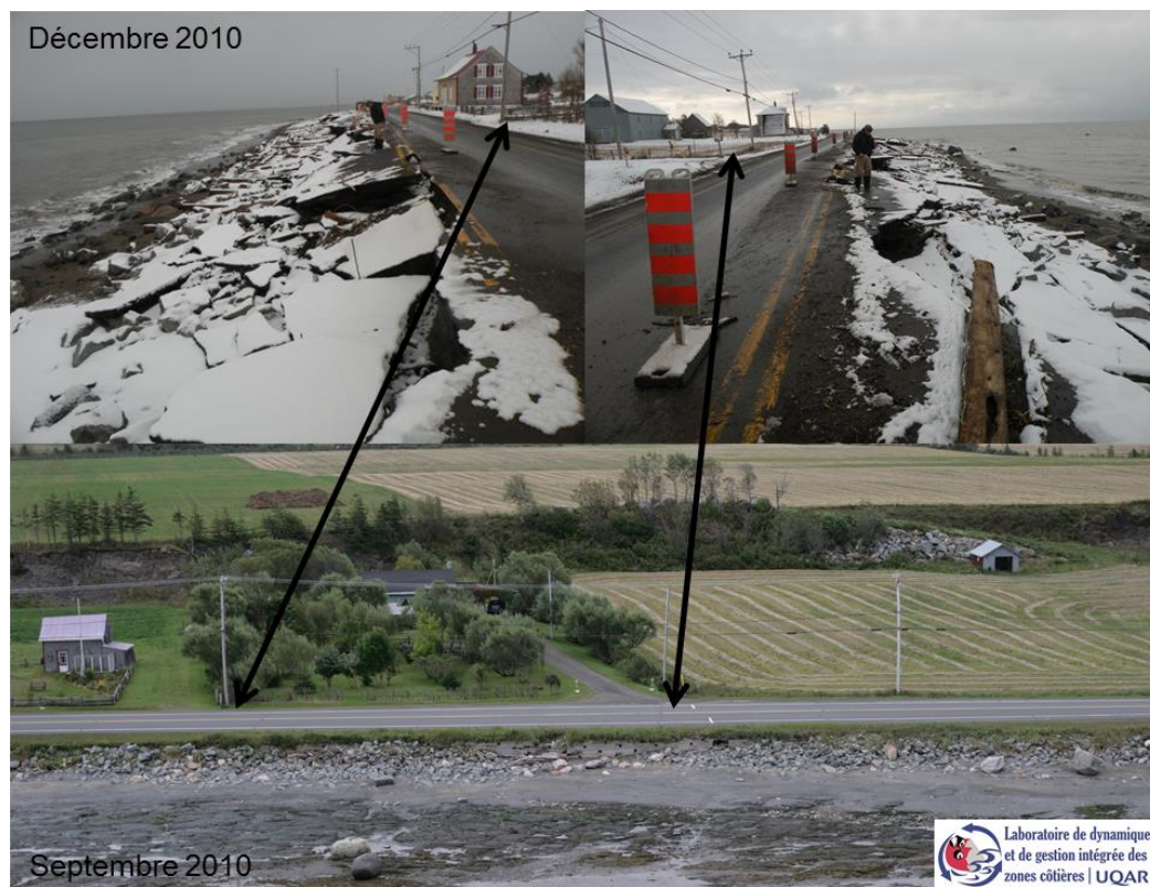
Figure 30. Haut : route 132 à Sainte-Flavie après la tempête du 6 décembre 2010. Bas : Route 132 en septembre 2010 avec la présence d'un enrochement et d'un muret de bois (© LDGIZC-UQAR)
