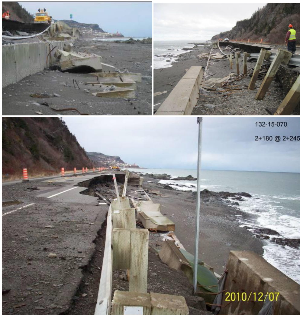
Figure 31. Murets de béton de protection de la route 132 partiellement détruits à la suite de la tempête du 6 décembre 2010 en Haute-Gaspésie (© MTQ)
