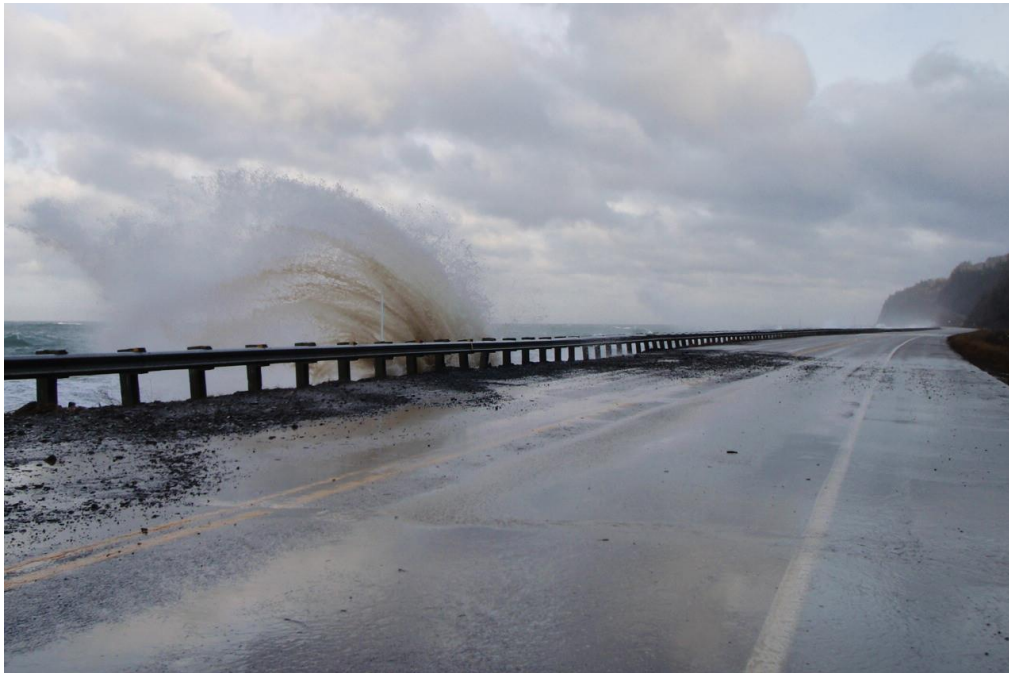
Figure 106. Vagues déferlant par-dessus le mur de protection de la route 132 sur la rive nord de la Gaspésie durant la tempête du 6 décembre 2010 (© LDGIZC-UQAR)
