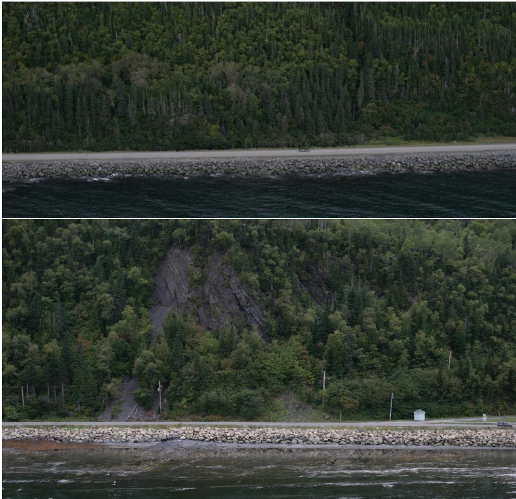
Figure 98. Segments avec une vulnérabilité à la submersion critique actuellement – segments RAC040 et 041 (haut) et RAC114 à 118 (bas) (© LDGIZC – UQAR, septembre 2010)
