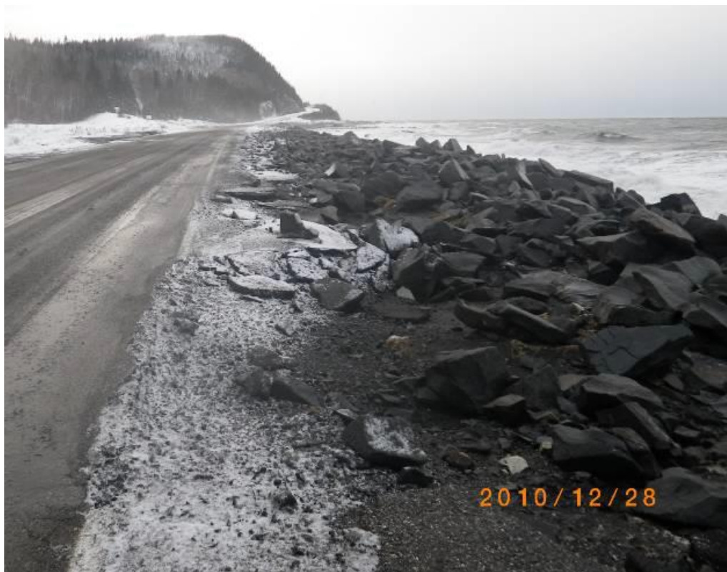
Figure 32. Entre Marsoui et Rivière-à-Claude à la suite de la tempête du 6 décembre 2010, érosion de l'accotement en arrière d'un enrochement (© MTQ)
