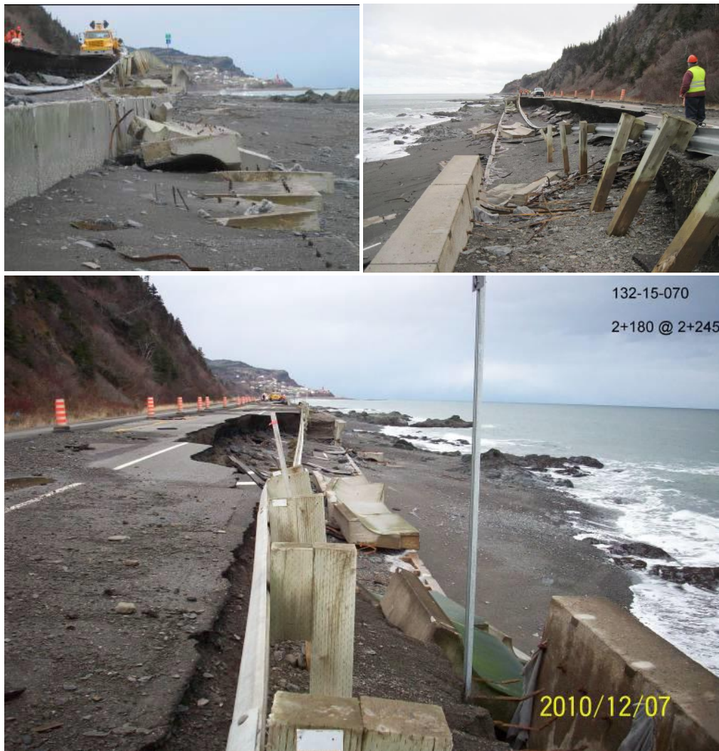
Figure 13. Suite à la tempête du 6 décembre 2010 en Haute-Gaspésie, murets de béton de protection et route 132 partiellement détruits
