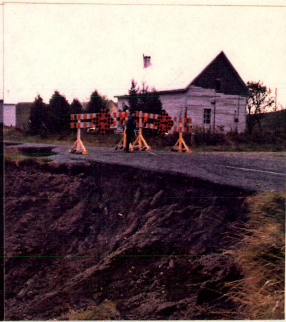
No 5: Coté nord-ouest de la route vis-à-vis du chainage 1+180 vers le sud; oct. 86.
