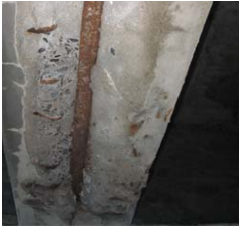
Figure 6. Dommage typique aux poutres
