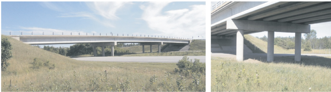
Figure 1 : Pont Chemin des Dalles : vue d'ensemble et vue d'un appui, [Roy, N. (2006)].
