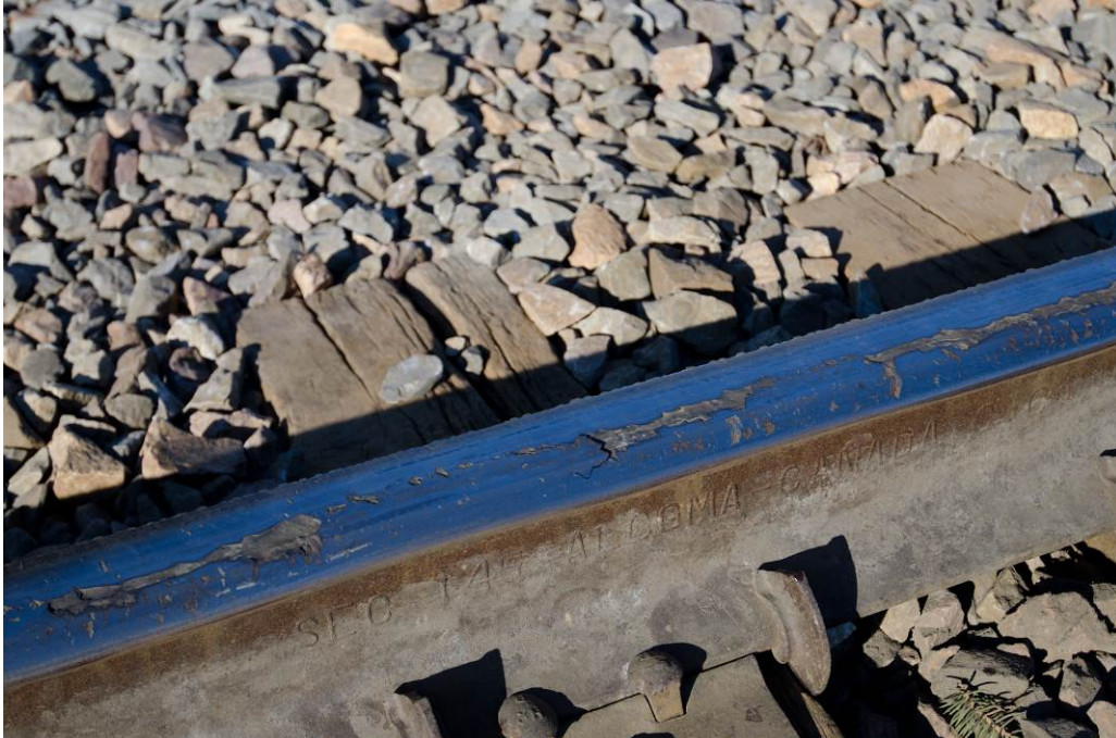
Figure 24 - Surface du rail endommagée vers le P.M. 12,35' de la subdivision Lacolle
