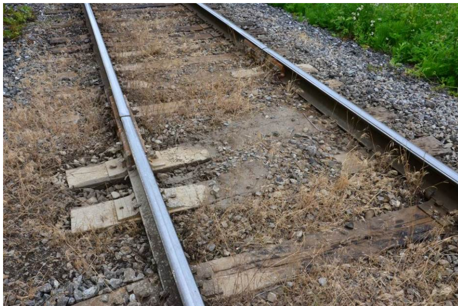
Figure 59 – Pompage et présence de boue et de végétation vers le P.M. 37,0
