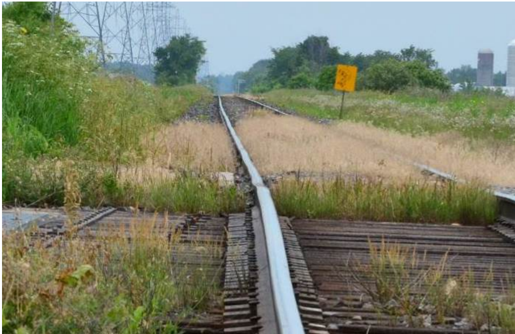
Figure 62 – Surface de roulement inégale vers le P.M. 27,0
