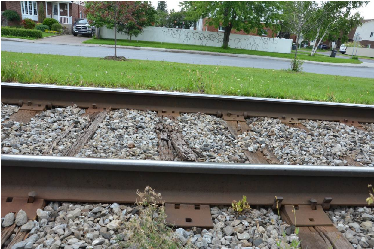
Figure 27 - Traverses en mauvais état et selle de rail où il manque des crampons vers le P.M. 42,0
