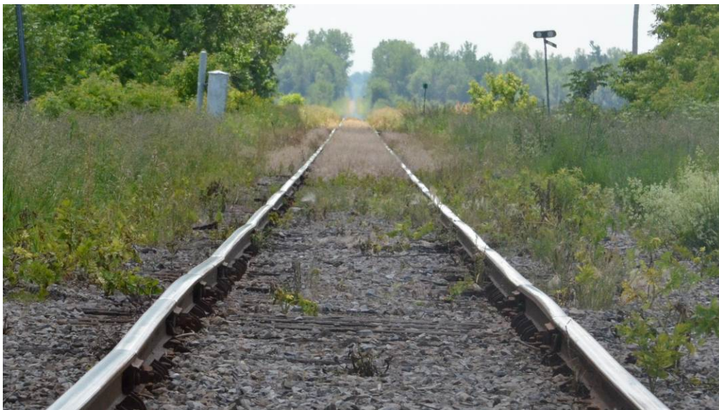
Figure 63 – Surface de roulement inégale et sections de rail courtes vers le point milliaire 5,0
