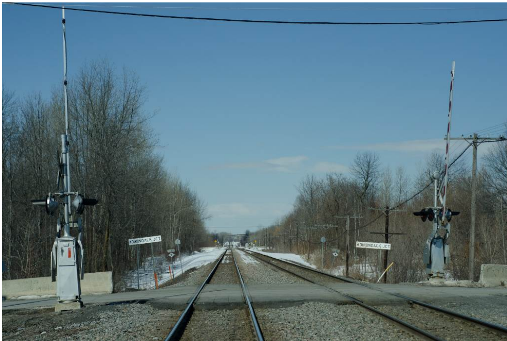
Figure 8 - Passage à niveau avec feux et barrières à Mohawk Trail Road au P.M. 39,05
