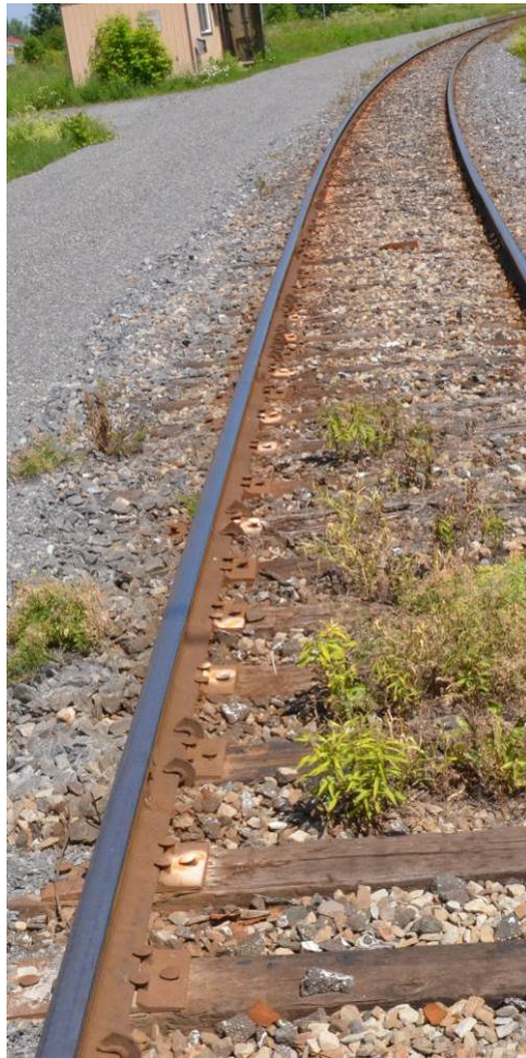
Figure 65 – Ballast contamin   et traverses marqu  es pour   tre remplac  es vers le P.M. 25,0
