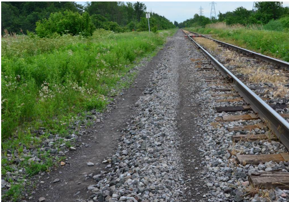
Figure 61 – Usure visible de l'épaulement due au passage de véhicules récréatifs, P.M. 32,0
