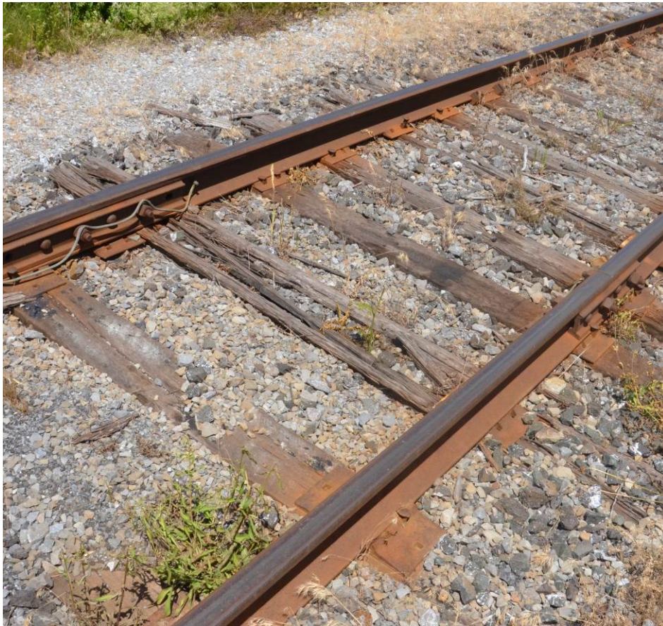
Figure 64 – État dégradé de la fondation de la voie au P.M. 3,5
