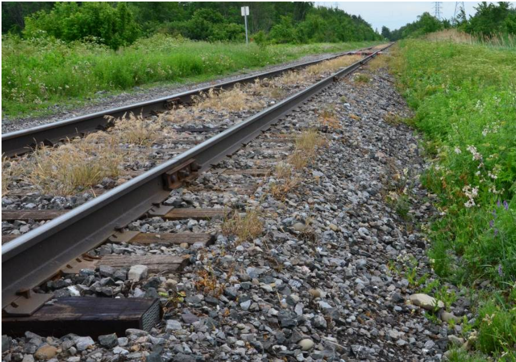
Figure 32 - Insuffisance de l'épaulement et contamination du ballast vers le P.M. 32,0
