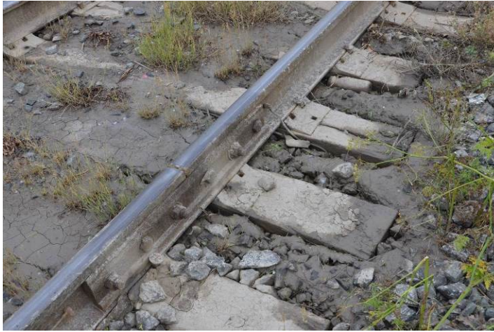
Figure 58 – Dégradation de l'assise de la voie sous l'action du pompage sur la subdivision Rouses Point
