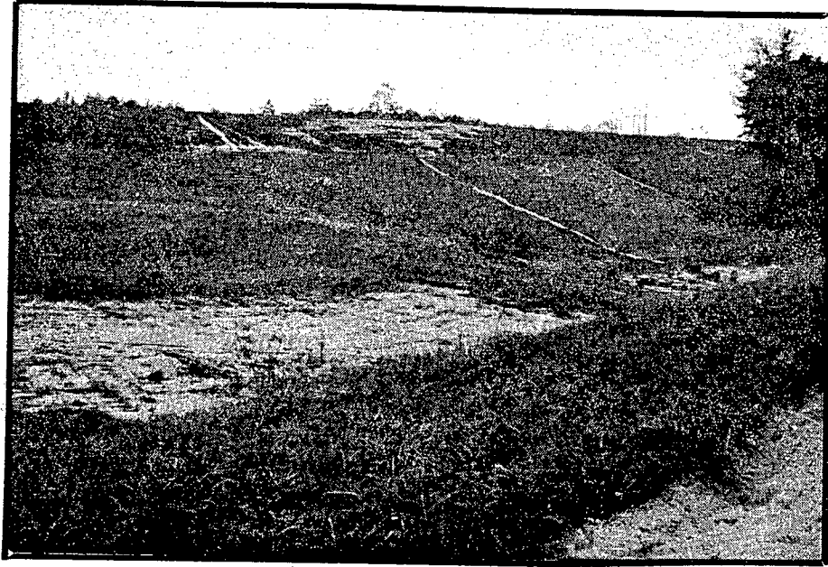
PHOTO 25: Tuyaux flexibles installés sur une pente sujette à l'érosion
