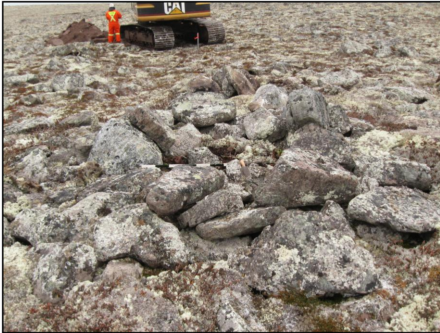
Photo 15 Monticule de pierres (St-3) localisé au chaînage 1+468, vers le sud-est (DUCD-0307-12-068)
