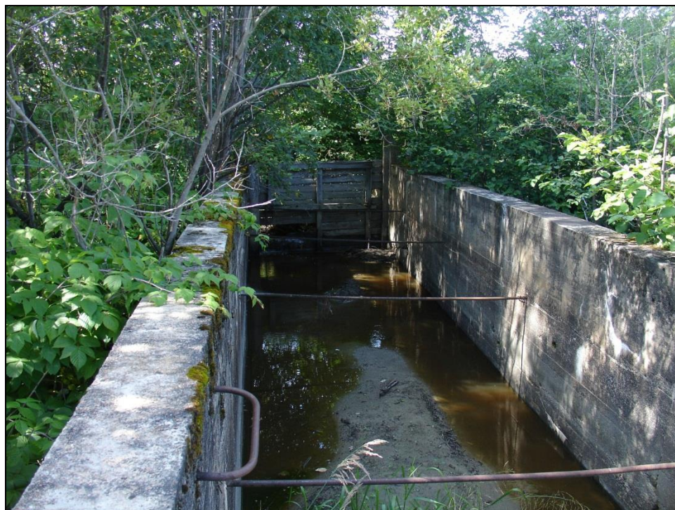
Photo 3 : projet 154-07-1774, municipalité de Normandin, aperçu du réservoir d'amené d'eau. Vue vers le sud.
