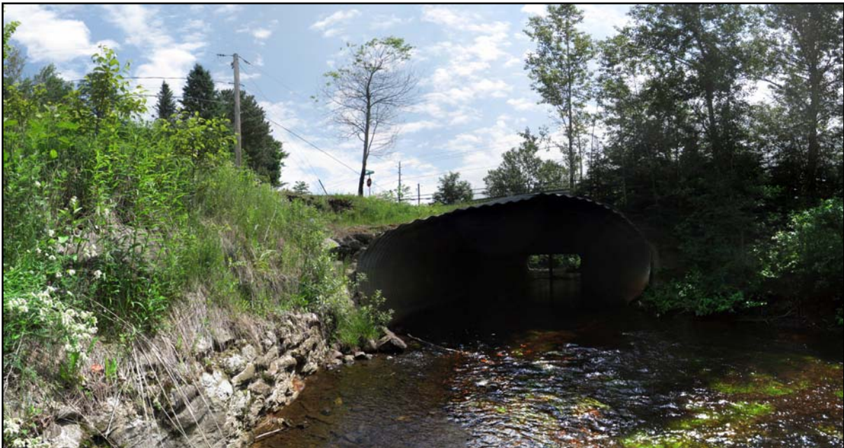
Photo 4 : Mur de soutènement et ponceau à remplacer, secteur 3, direction sud-est (photographie : Mathieu Sévigny)
