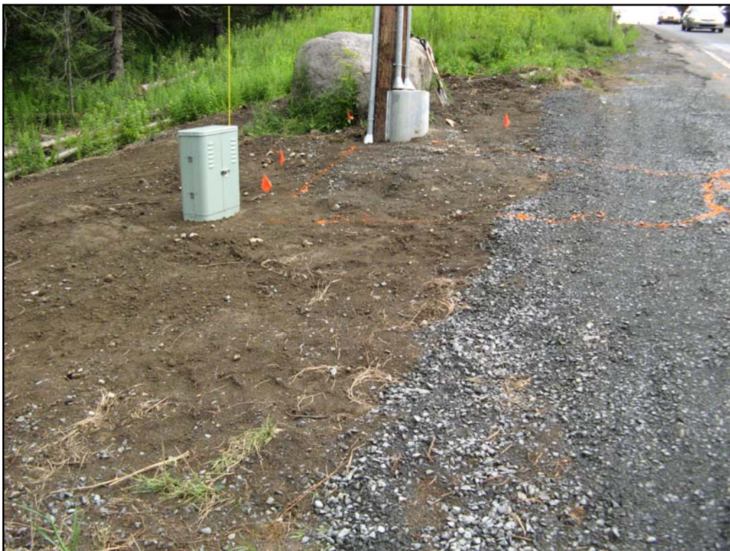
Photo 18 : Câbles souterrains de Bell Canada, secteur 2, direction nord (154-06-1048-10-NUM1-6)
