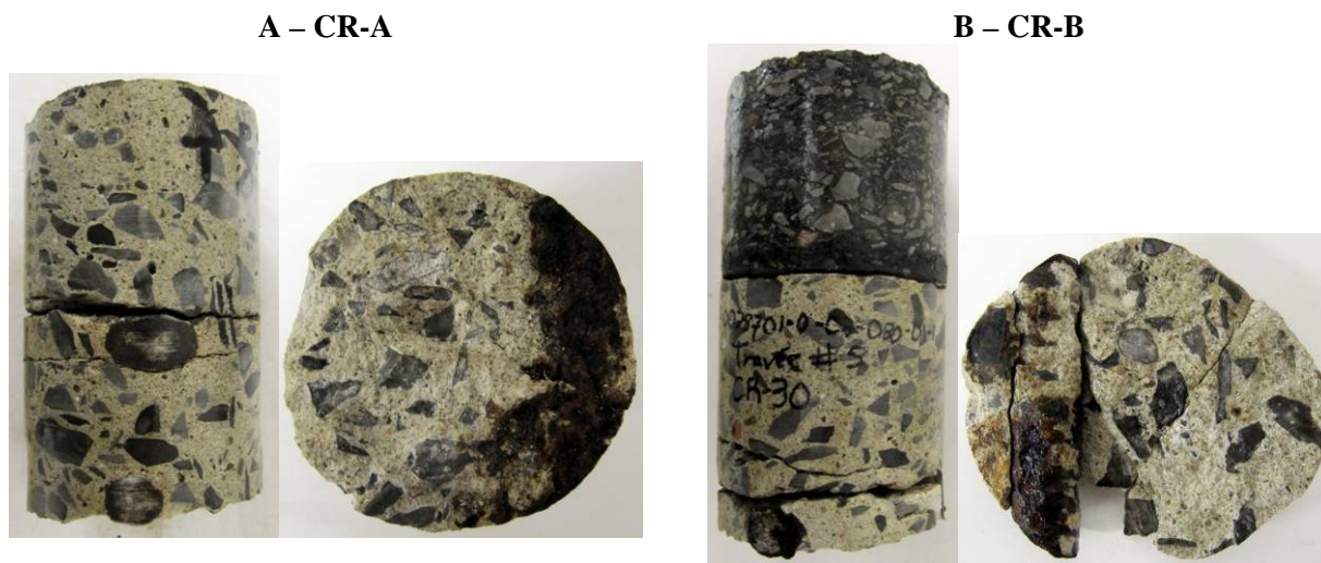
Figure 7 : Carottes de béton prélevées dans une zone où l'activité de corrosion est élevée
