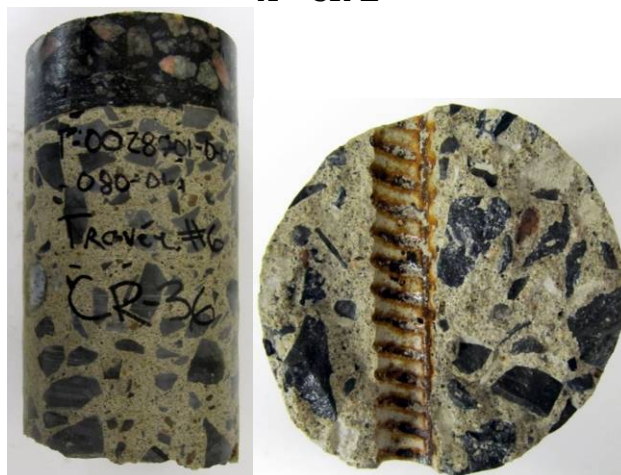
Figure 11 : Carotte de béton prélevée dans une zone où l'activité de corrosion est faible
