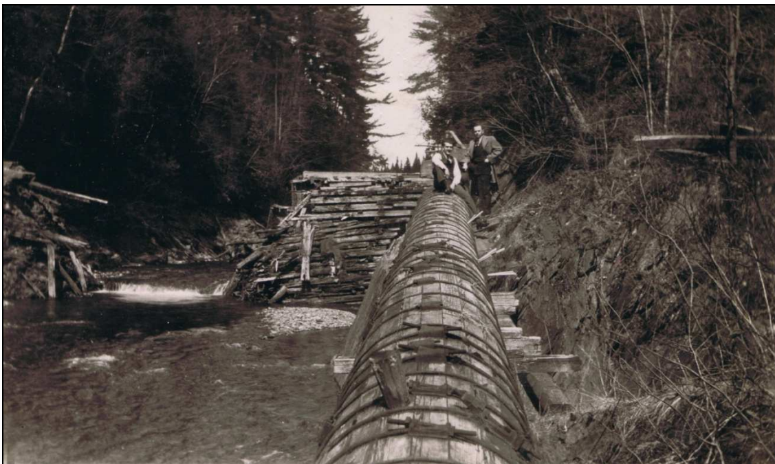
Photo 7 : Barrage détruit par la crue qui a endommagé le second moulin banal de la seigneurie de Taschereau sur la rivière Chassé, à Sainte-Marie, vers 1937
