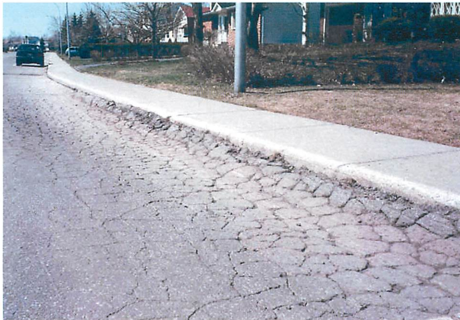
Figure 1.8 Fissures créées par un excès d'eau au printemps dans la fondation.
