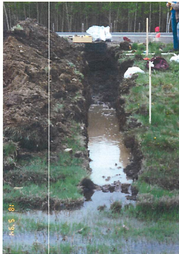
Figure 6.3 Saignée sur autoroute existante sans système de drainage, autoroute #15.
