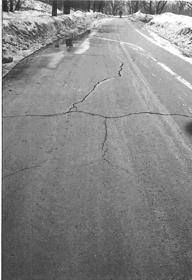
Figure 1.4 Fissures créées par le soulèvement différentiel en hiver.
