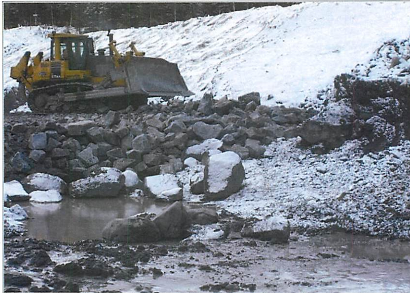
Figure 4.7 Enrochement utilisé sur la route #175 dans un déblai de sable silteux.
