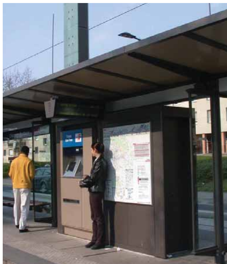
ORLÉANS - ARMOIRE TECHNIQUE DE QUAI, BILLETTERIE ET ARMOIRE TECHNIQUE INTÉGRÉE
