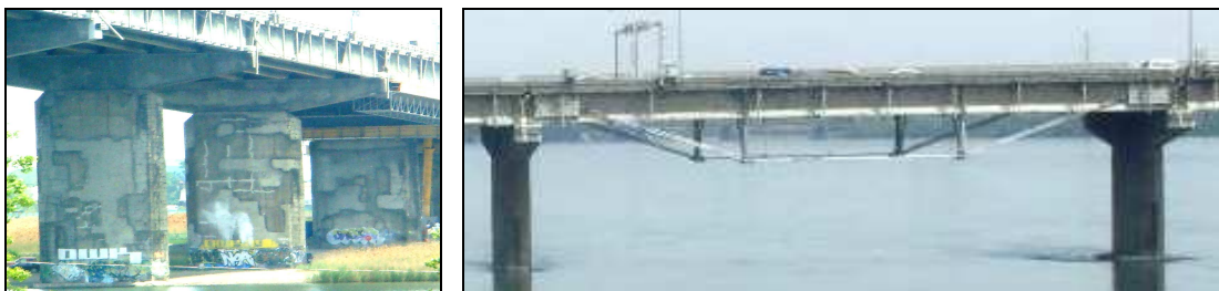
Figure 15 – Exemples de la détérioration : Piliers du côté de la Rive-Sud et renforcement des poutres d'extrémité
