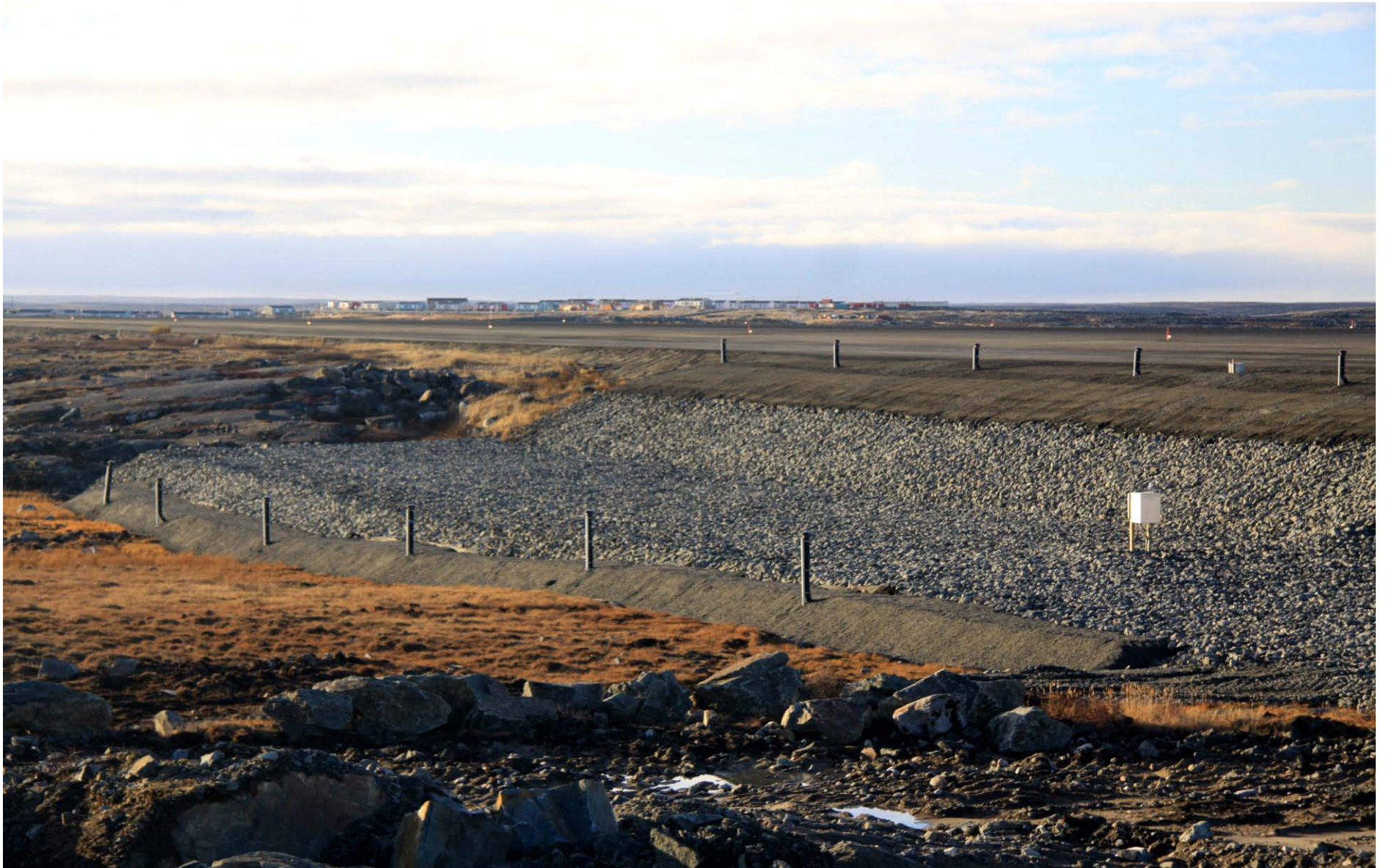
Figure 16 Nouvelle station d'acquisition de données pour F2, installée sur la berme à convection.
