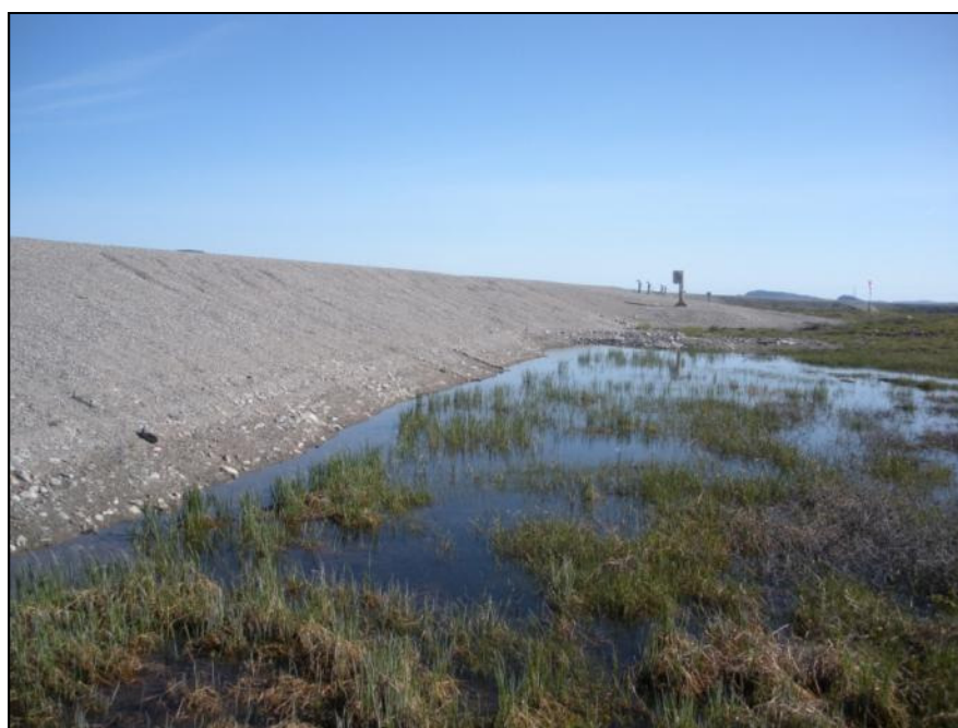
Figure 30. Accumulation d'eau au pied de la section de référence en juillet 2009.
