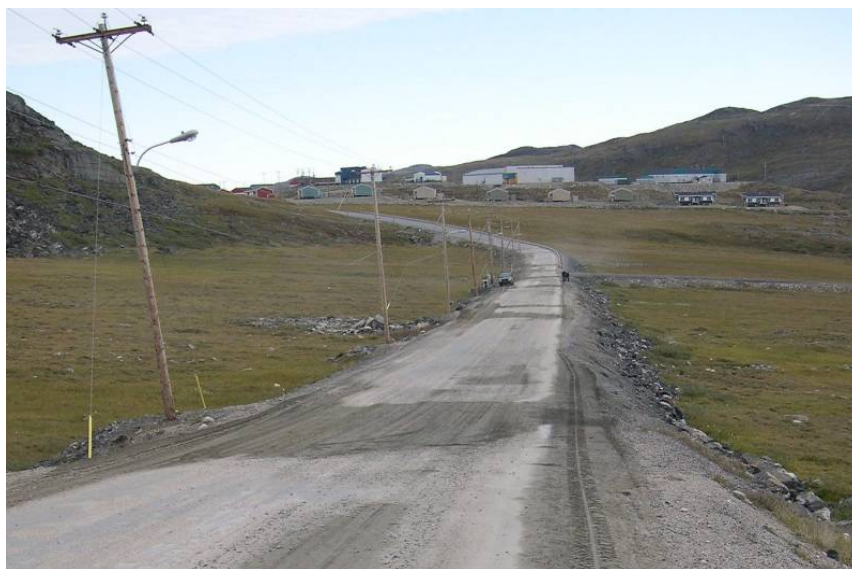
Figure 5-3 : basculement des poteaux de la ligne de transport électrique
