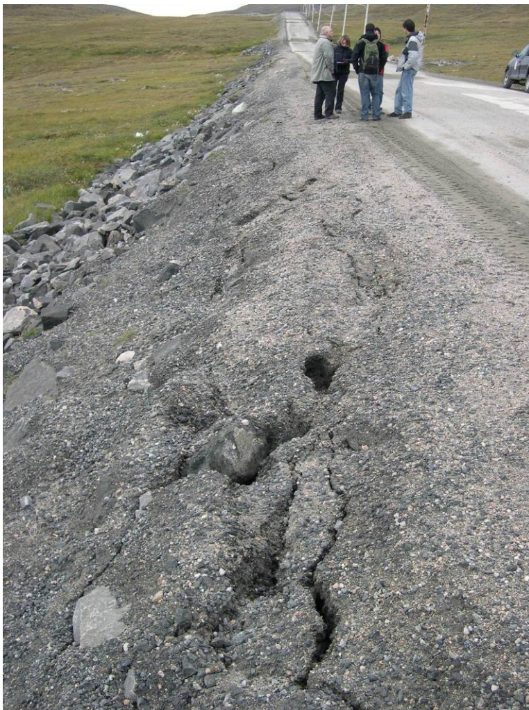
Figure 5-2 : Fissures dans l'épaulement du remblai de la route de Salluit
