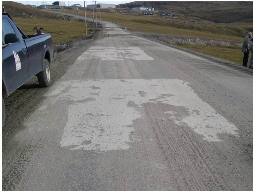
Figure 5-8 : Condition des surfaces réfléchissantes
