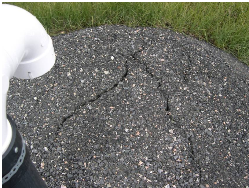
Figure 5-6 : Signes d'affaissement des tumulus supportant les systèmes de ventilation
