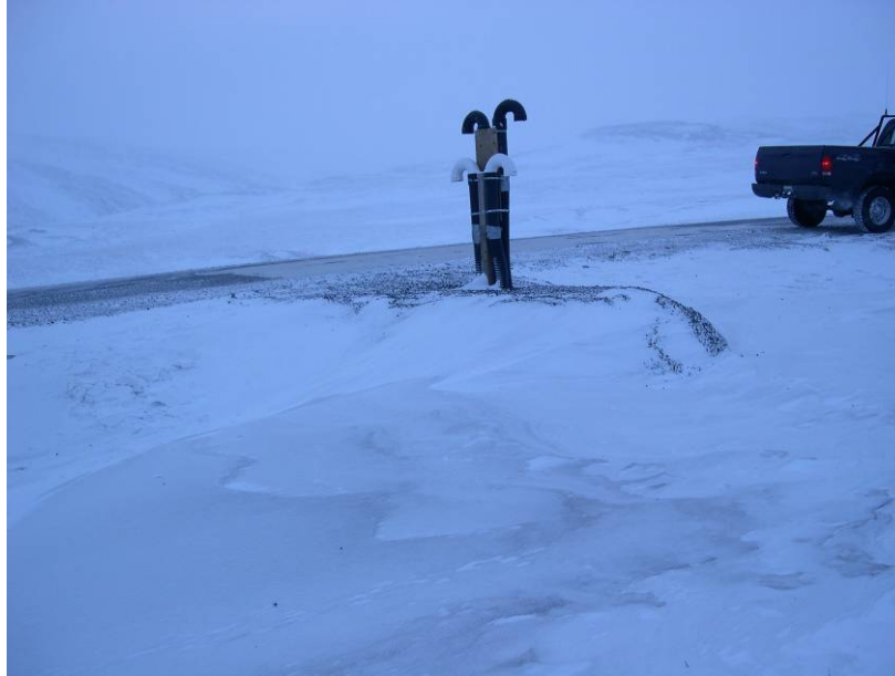
Figure 5-5 : Conduites de ventilation telles qu’observées à l’hiver 2008
