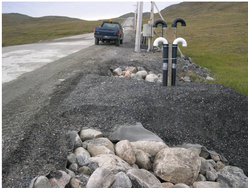
Figure 5-4 : Vue des conduites de ventilation et de l'ensemble des sections d'essai
