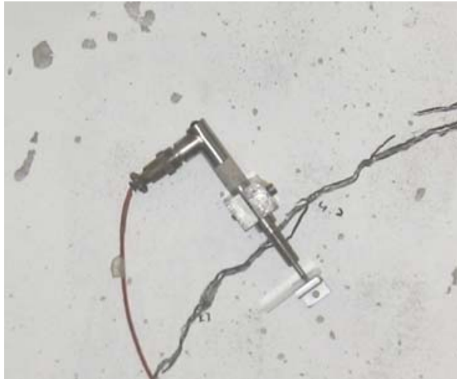
Figure 9 : LVDT au droit d'une fissure de cisaillement
