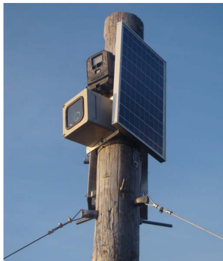
Figure 74 Exemple d'installation des caméras
