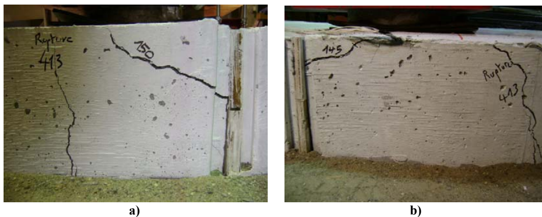
Figure 3.95 : Réseau de fissure à la rupture après 1 million de cycles (dalle PRFV 38,1 mm)
