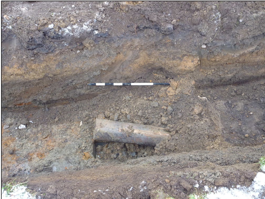
Photo 5 : Projet n° 154-06-0225, poteau de bois 1A20, chaînage 4+122, rang Bois-Franc Ouest, municipalité de Notre-Dame-du-Sacré-Cœur-d'Issoudun, direction sud-est (photo n° 154-06-0225-7)
