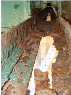
a) Corrosion importante de la corde inférieure
