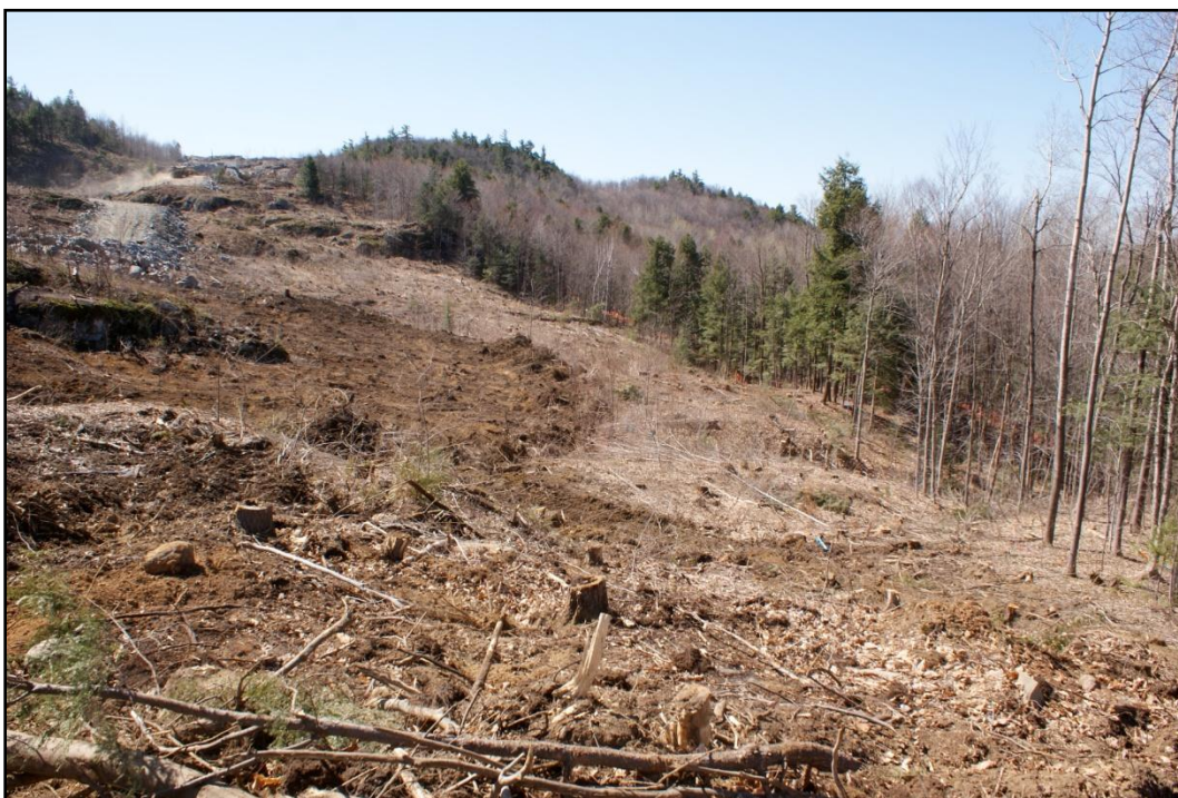
Photo 30 Déboisement et perturbation des sols causés par la machinerie lourde, zone de Papineauville, secteur 8, direction est
