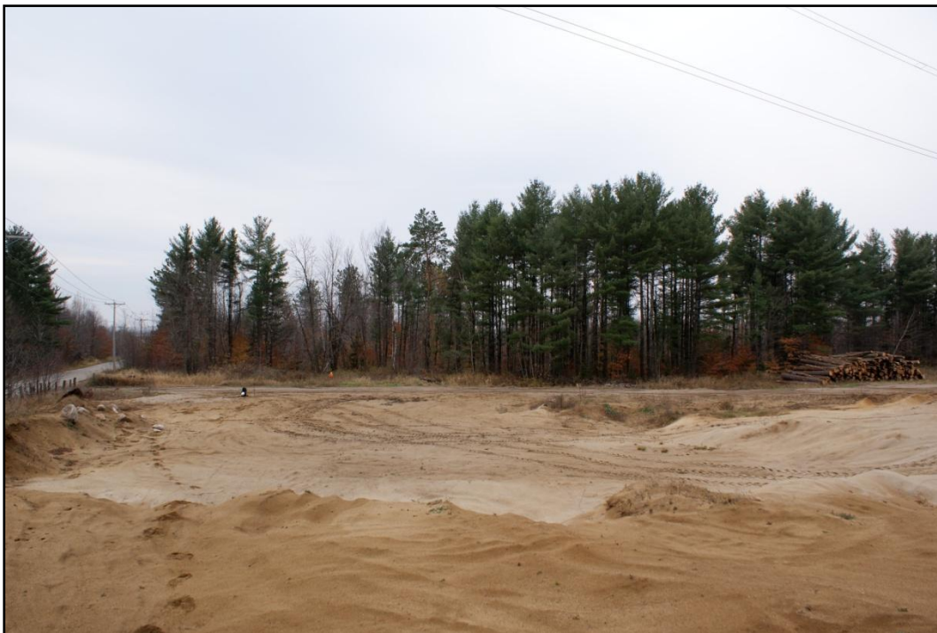
Photo 11 Secteur 3, au nord de l'emprise, vers le chaînage 129+550, zone Plaisance est, secteur 3, direction sud-ouest
