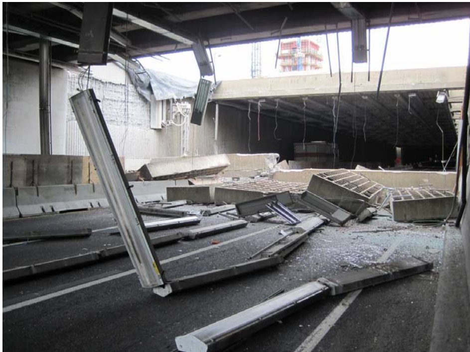
Photo 1 – Vue générale du site d'effondrement de la poutre P2
