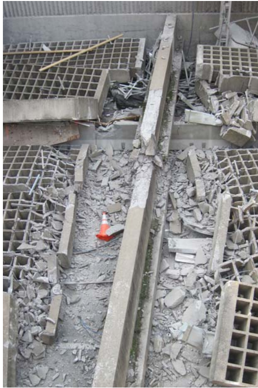
Photo 5 – Rupture de la poutre P2 par impact sur le parapet
