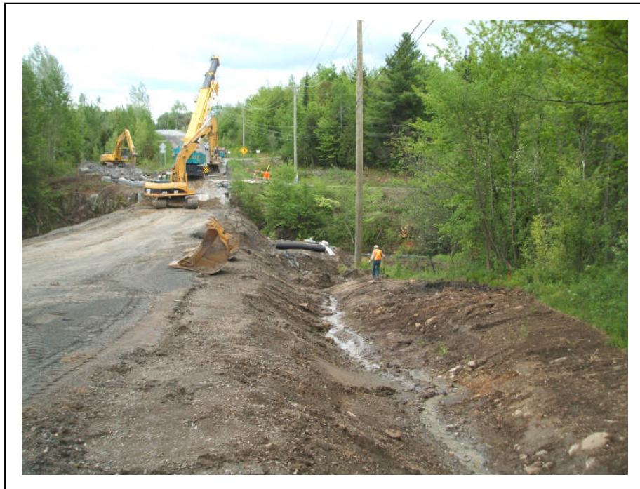
Photo 8 : Projet no. 154-91-2227, ville de Magog, chemin des Pères (chemin Bolton-est), km 6+040, secteur 2, environnement, vers le sud (N.1-13)
