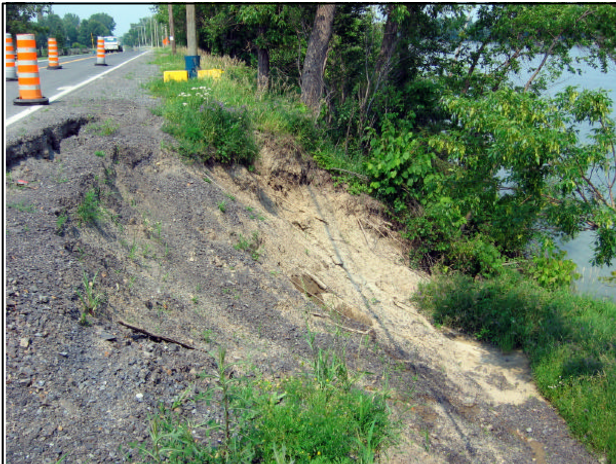
Photo 9 : Érosion du talus de la route 223, municipalité de Saint-Marc-sur-Richelieu, direction nord (20-5371-05C8-06-NUM1-2).
