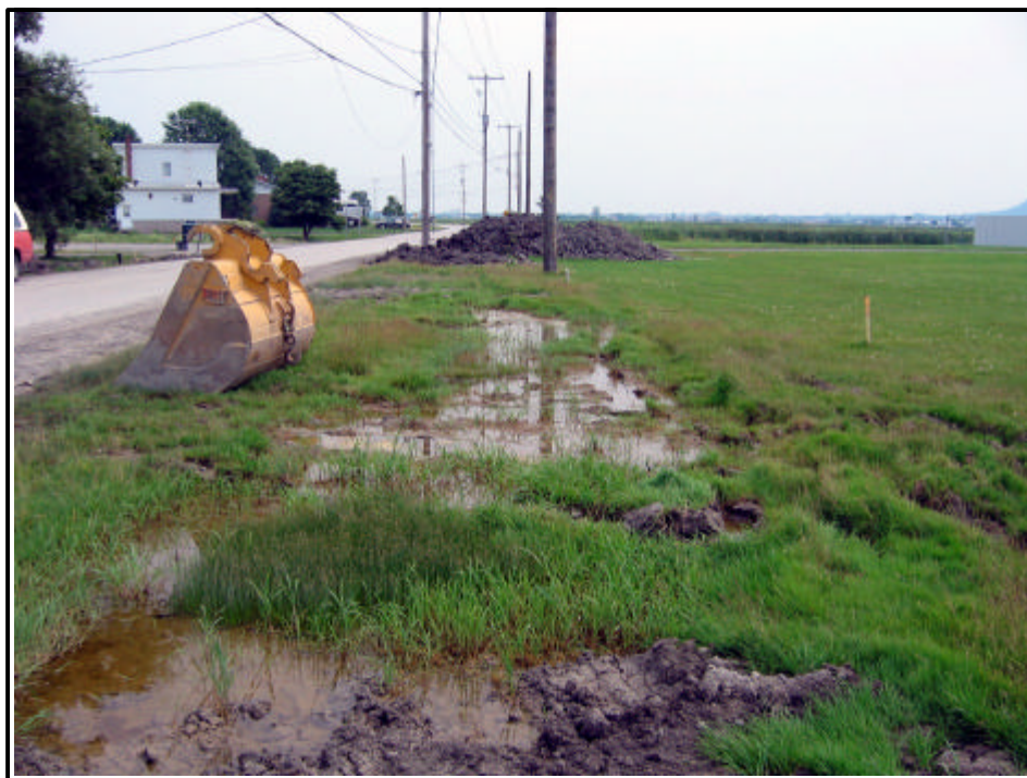
Photo 1 : Terrain mal drainé, secteur 1, côté sud du chemin Trudeau à l'est de la route 229, municipalité de Saint-Mathieu-de-Beloeil, direction est (20-5371-02D4-X2-06-NUM1-8).
