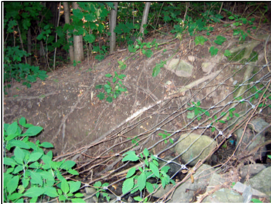
Photo 7 : Substrat rocheux mise à nu par l'érosion, secteur 2, municipalité de Mont-Saint-Hilaire, direction sud-ouest (20-5371-05C2-06-NUM1-9).
