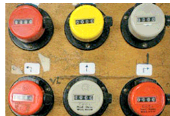
Compteurs mécaniques sur planchette
