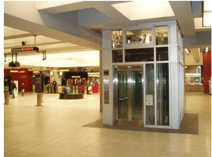
Ascenseur Berri-UQAM 15 ascenseurs installés dans 5 stations
