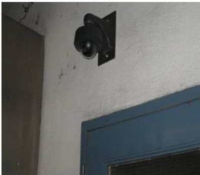
1800 caméras installées dans le réseau
