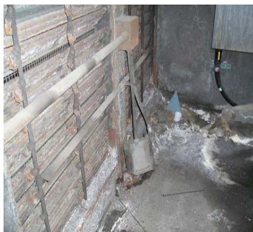
Ancien volet motorisé
