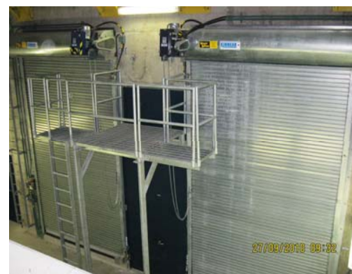
Nouvelle porte motorisée
