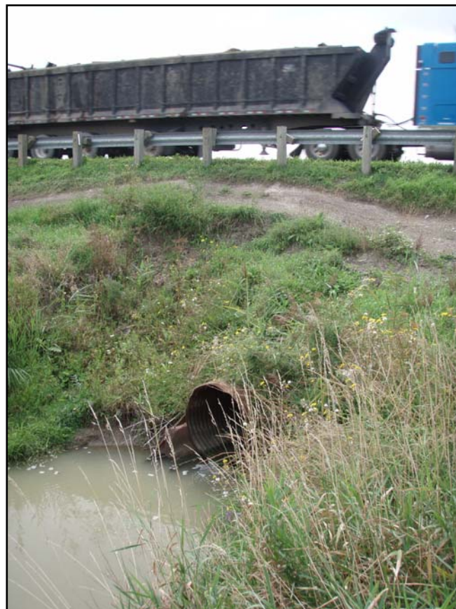
Photo 12 : Extrémité nord du ponceau à remplacer, direction sud-ouest (154-06-0844-08-NUM1-9)
