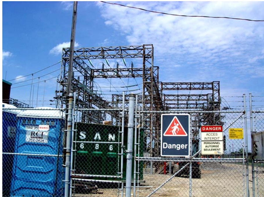
Photo 4, Poste de transformation d'Hydro-Québec
