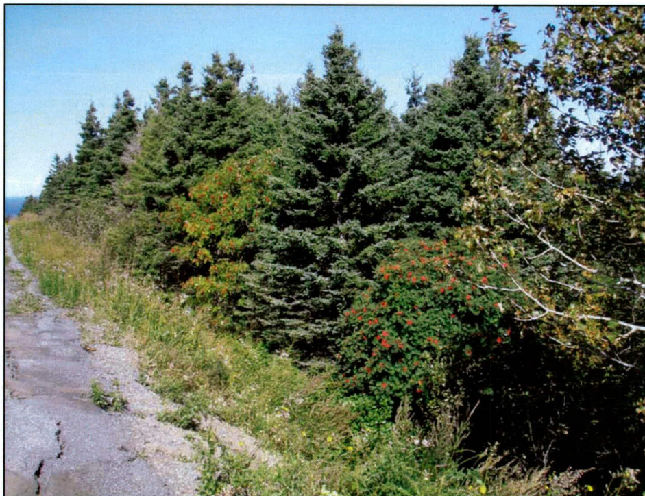
Photo 20 Projet n° 154-07-0651 - Vue générale du talus de la route 132 devant être stabilisé, vers le nord (Sainte-Madeleine-de-la-Rivière-Madeleine_5)
