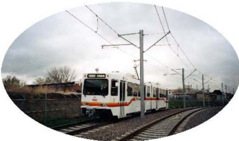
FIGURE 19 - Exemple de caténaire centrale
