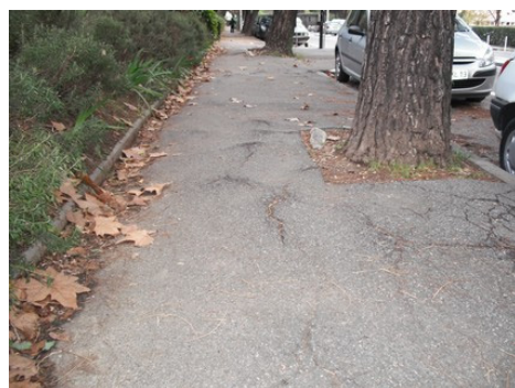
Racines ayant déformé la planéité de la surface et pouvant former des entraves (difficilement décelables pour les PAM) (Source : Cete Méditerranée)
