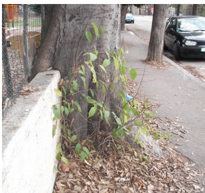
Arbre « adulte » ayant été planté à l'origine trop près d'un mur de clôture (Source : Cete Méditerranée)
