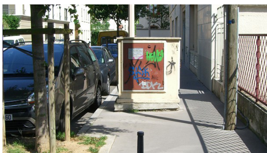
Implantation d'une armoire électrique réduisant la largeur du cheminement (Ville de Lyon) (Source : Certu)
