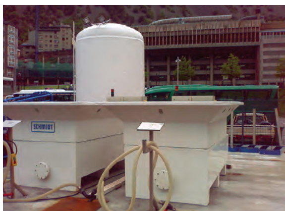
14- Station de production de saumure
