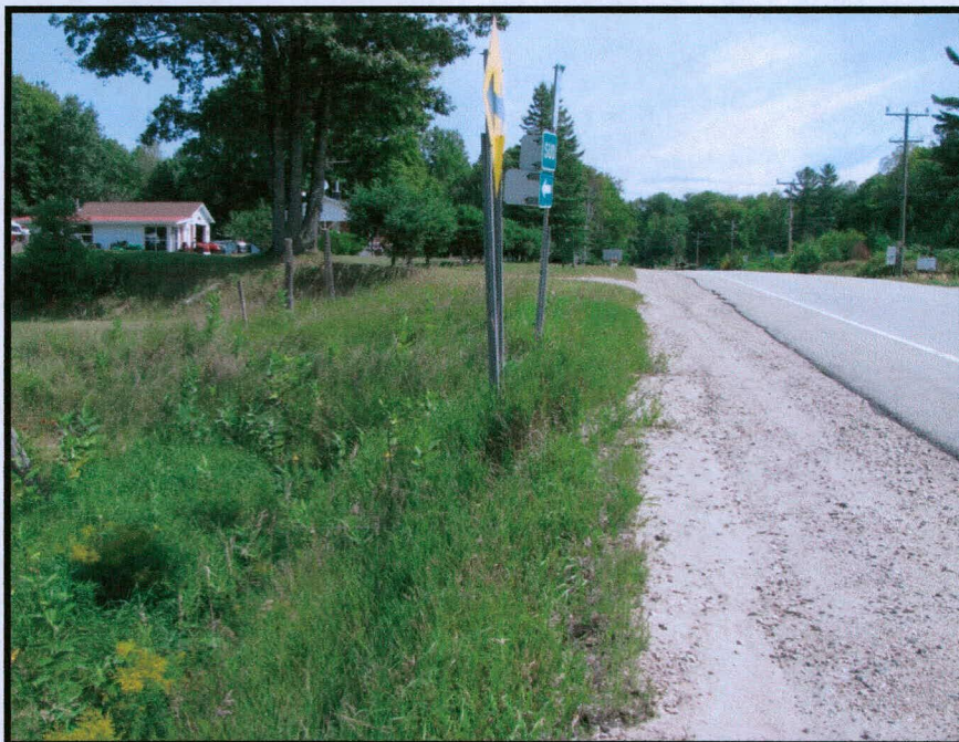
Photo 9 : Projet 154-05-1592, fossé et terrain résidentiel remblayés, coté ouest de la route 105, chemin Calumet et route 105, municipalité de Gracefield, direction nord (MTQ-L5.22)
