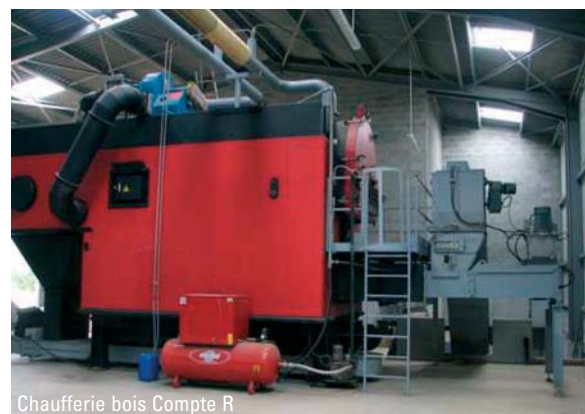
Chaufferie bois Compte R
