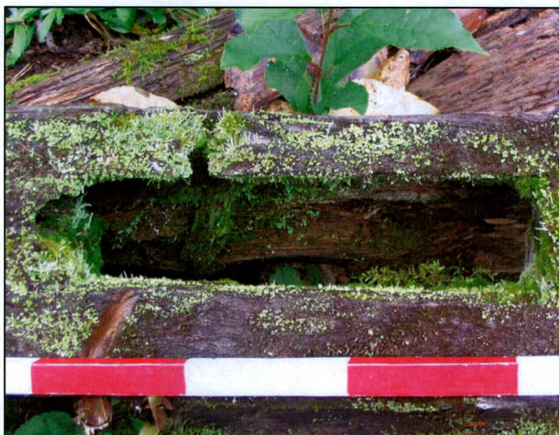
Photo 32 : Projet n° 154-99-0643, mortaise visible sur une pièce équarrie associée au moulin dans le secteur "C", en direction nord (MRLOU08.169)
