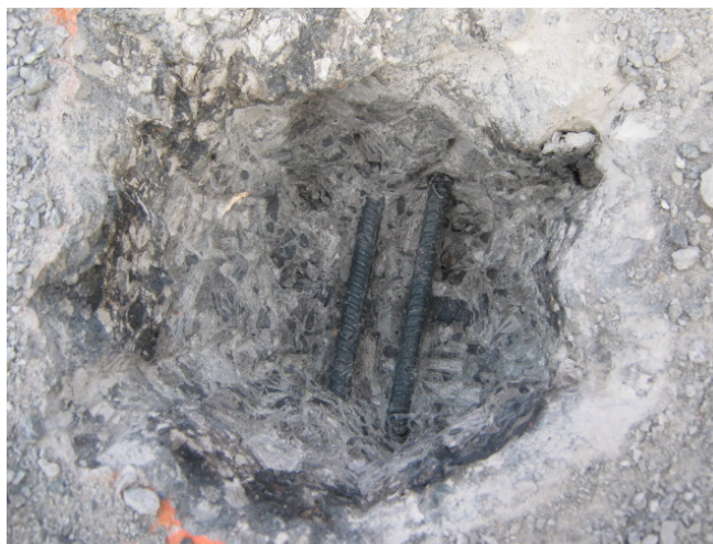
Fig. 12 : Point de contrôle des armatures – aucune perte de section
