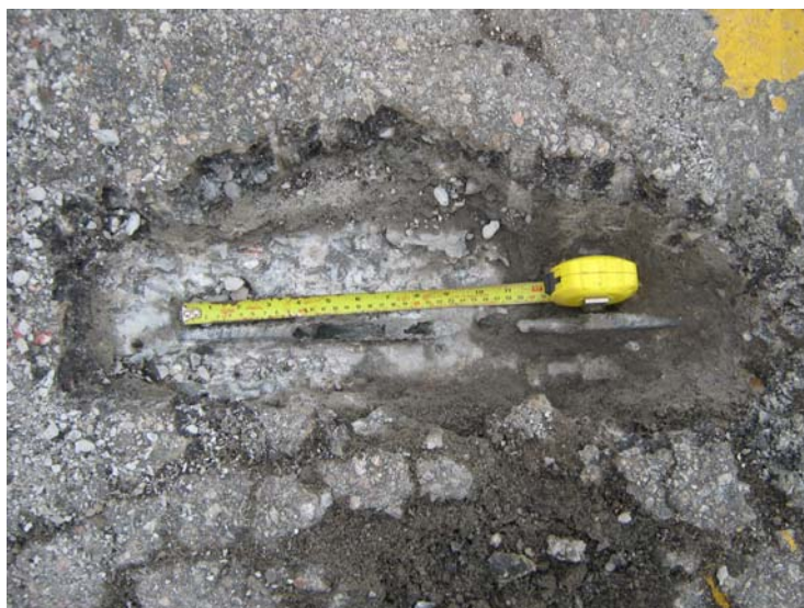
Fig. 10 : Point de contrôle des armatures – perte totale de section
